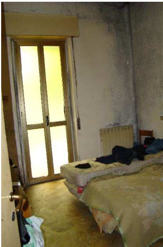
14. Vista della camera: presenza di muffe.
