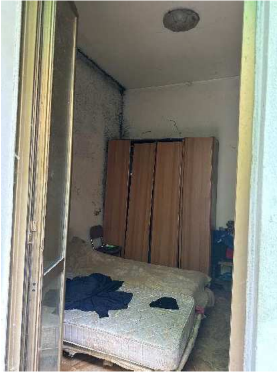
15. Vista della camera: presenza di muffe.
