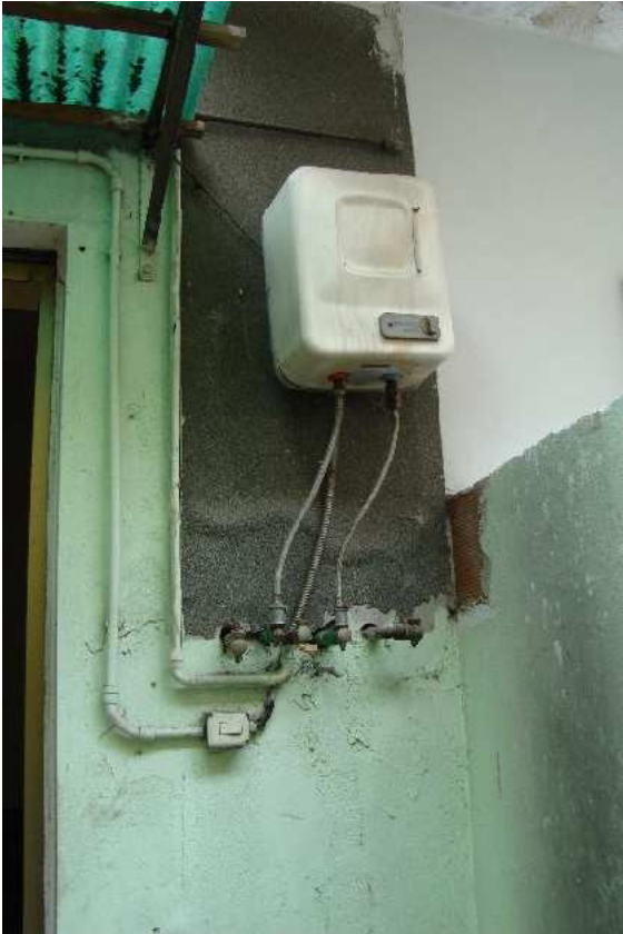
5. Dettaglio della caldaia esterna (non funzionante).
