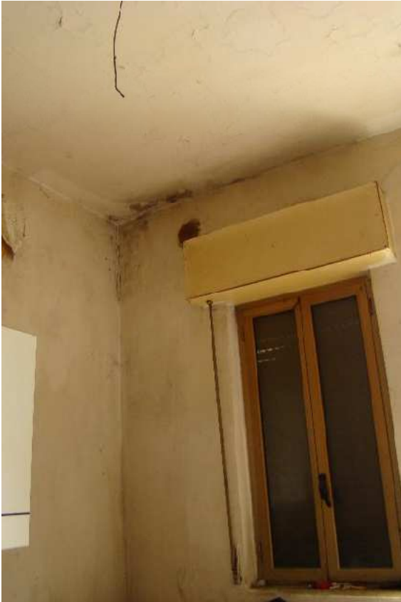
11. Dettaglio interno: presenza di muffe.
