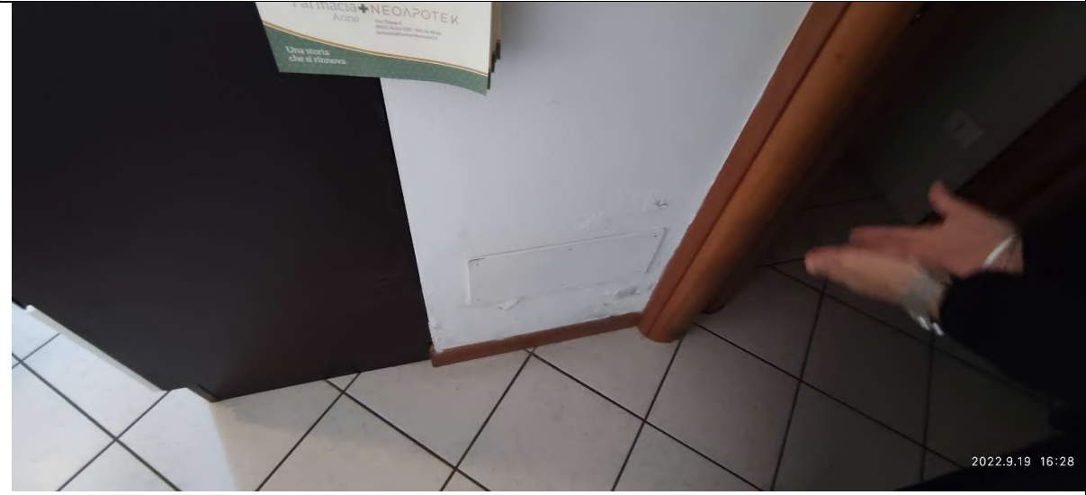
FOTO 11_TRACCE DI UMIDITA' ZONA SOGGIORNO-ANGOLO COTTURA
