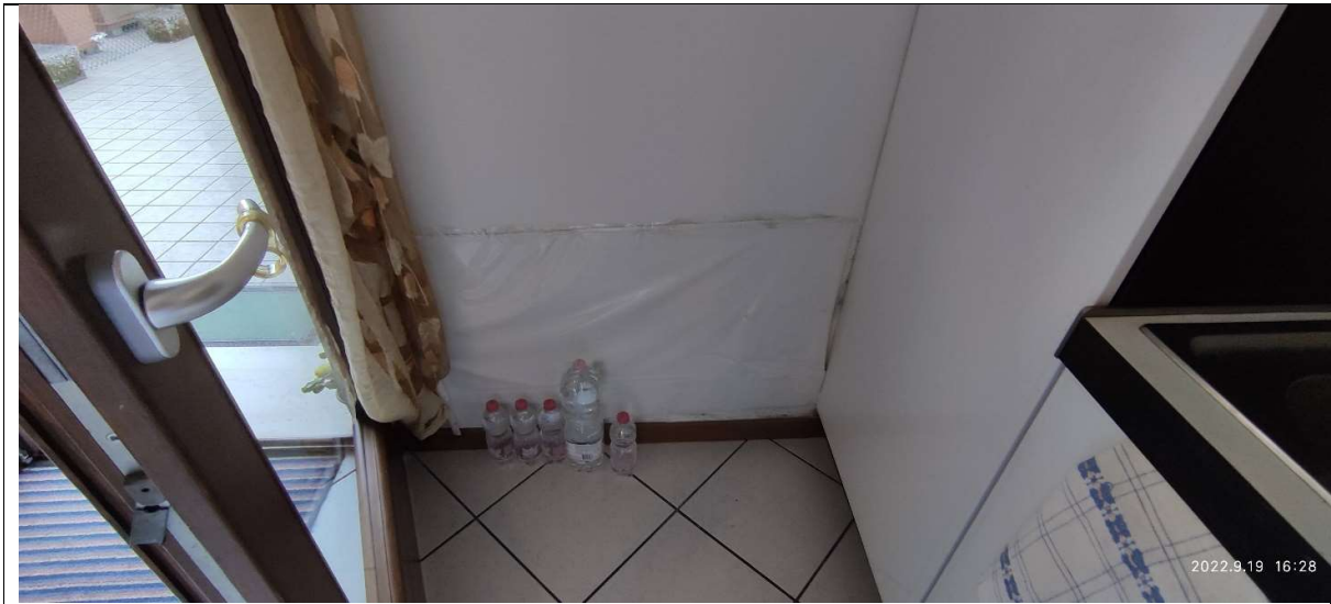
FOTO 12_TRACCE DI UMIDITA' ZONA SOGGIORNO-ANGOLO COTTURA
