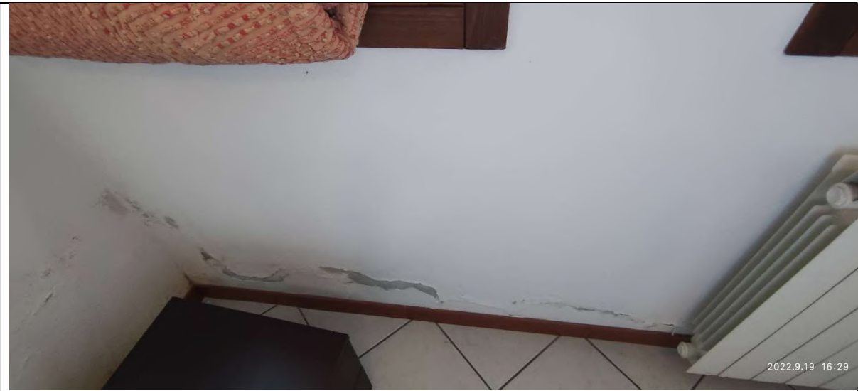
FOTO 10_TRACCE DI UMIDATA' SU CAMERA
