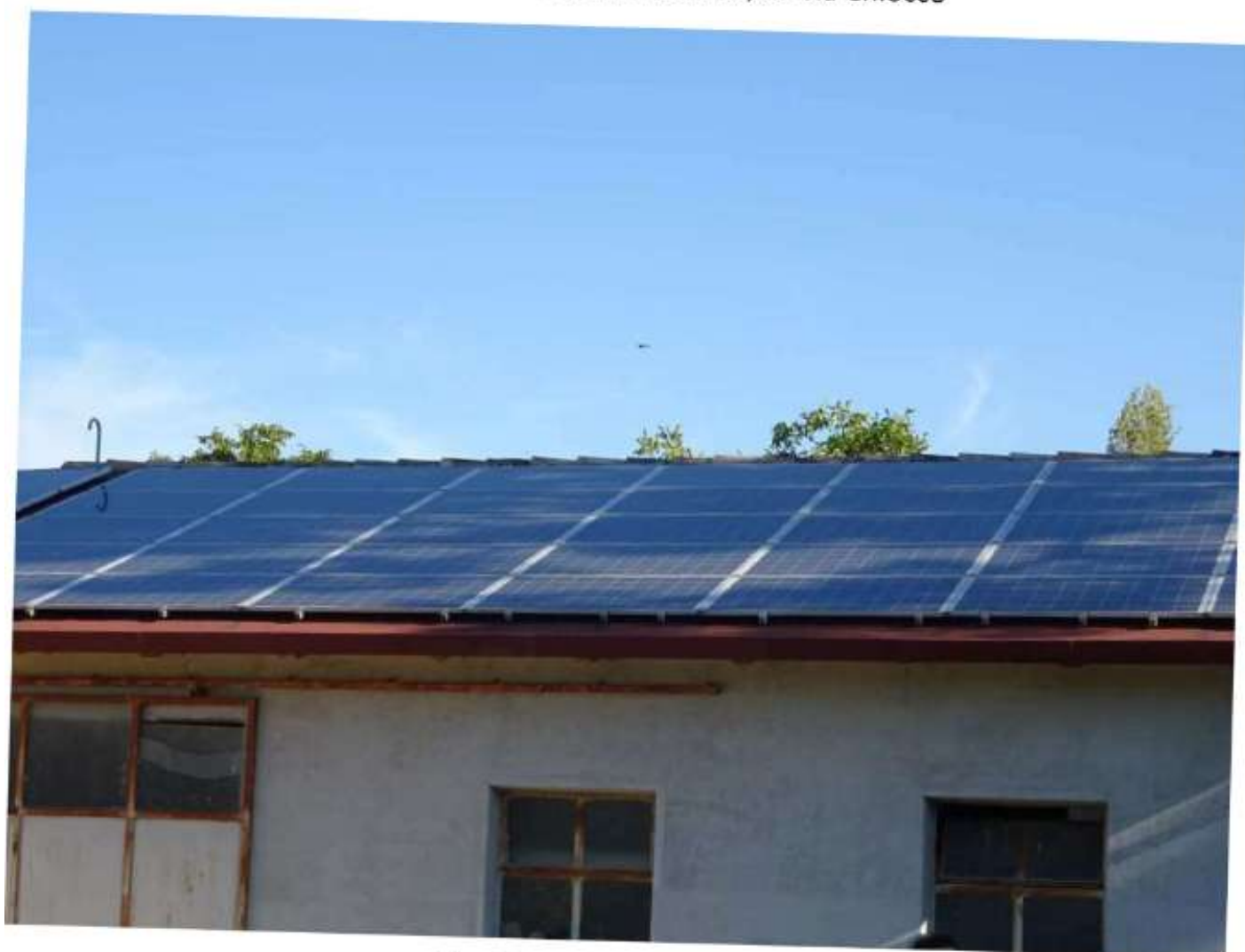
7. Particolare pannelli fotovoltaici
