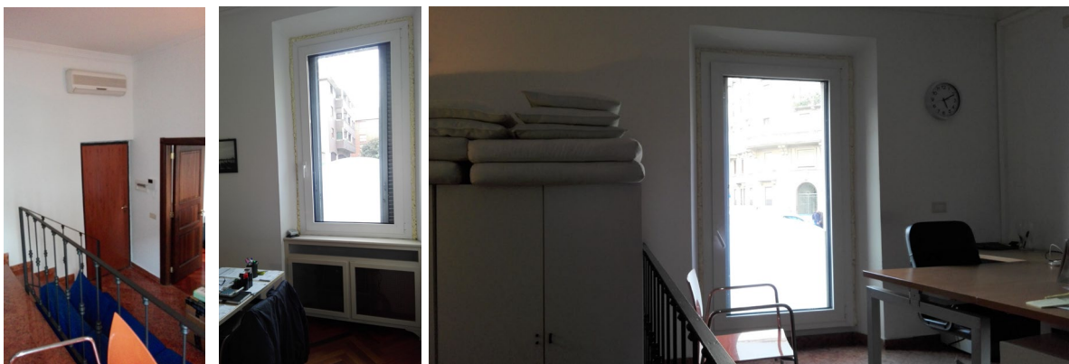
Fig. 53: veranda abusiva (interno/esterno)
