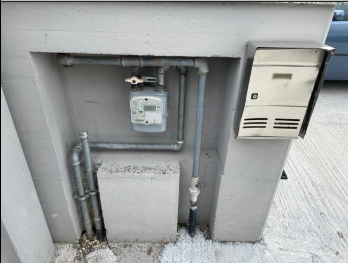
Contatore gas esterno
