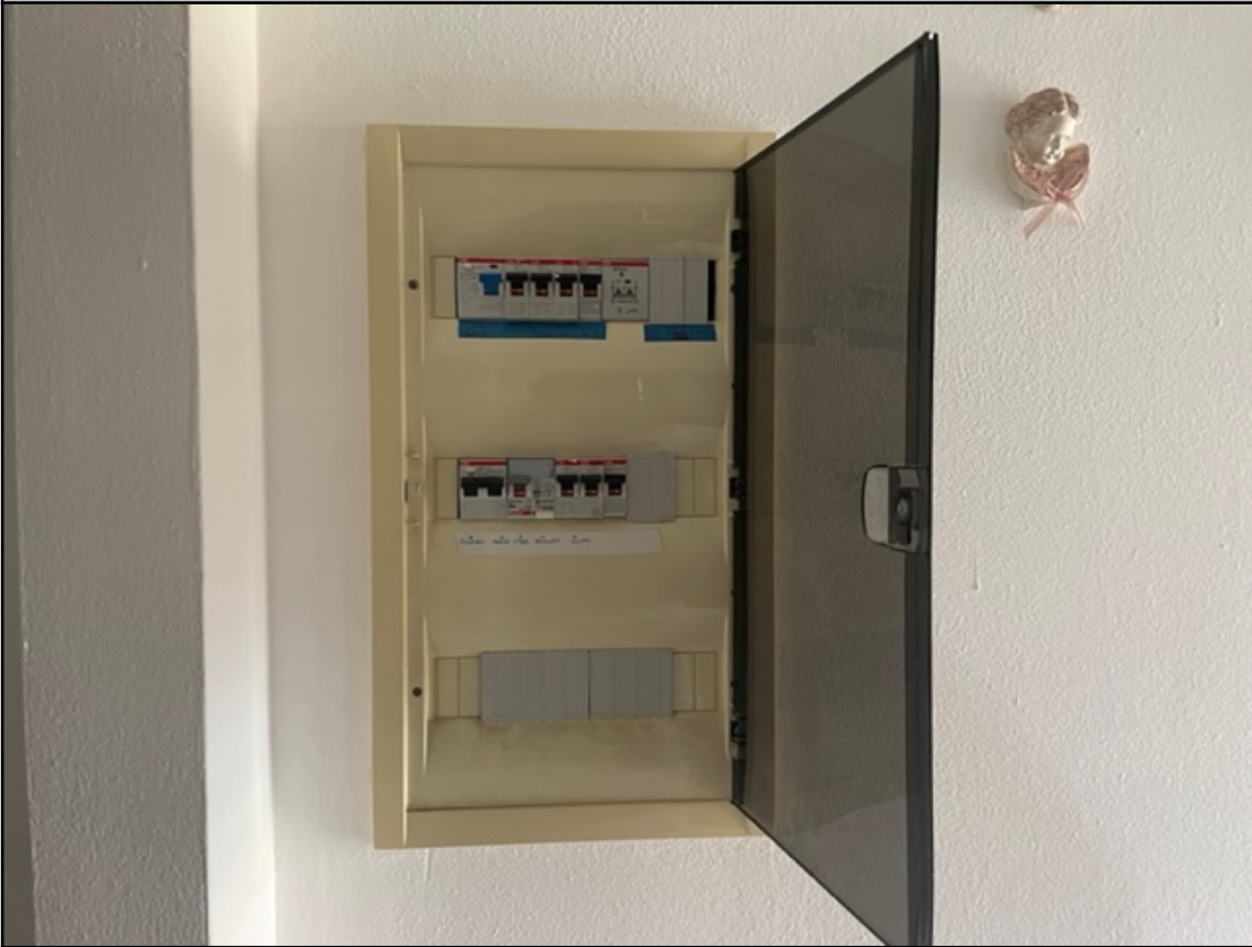
Particolare quadro elettrico
