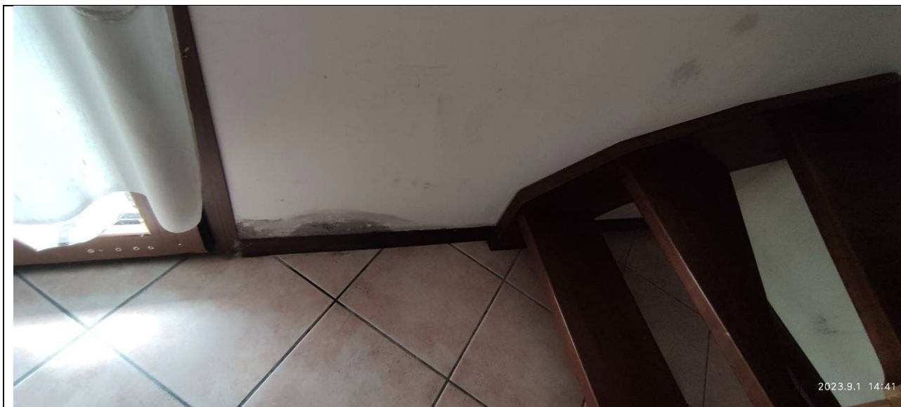
FOTO 18_PIANO TERRA/ AUTORIMESSA / PARTICOLARE UMIDITA' DI RISALITA VERSO SUD-OVEST
