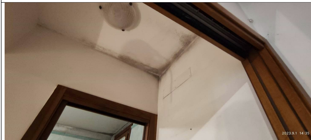
FOTO 19_PIANO SECONDO/ VANO SCALA/ PARTICOLARE INFILTRAZIONE E/O CONDENZA SU SOFFITTO
