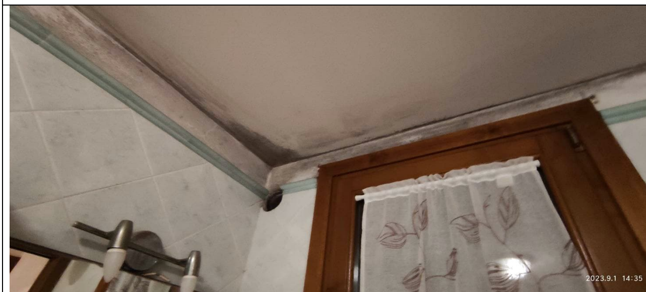
FOTO 20_PIANO SECONDO/ BAGNO/ PARTICOLARE INFILTRAZIONE E/O CONDENZA SU SOFFITTO
