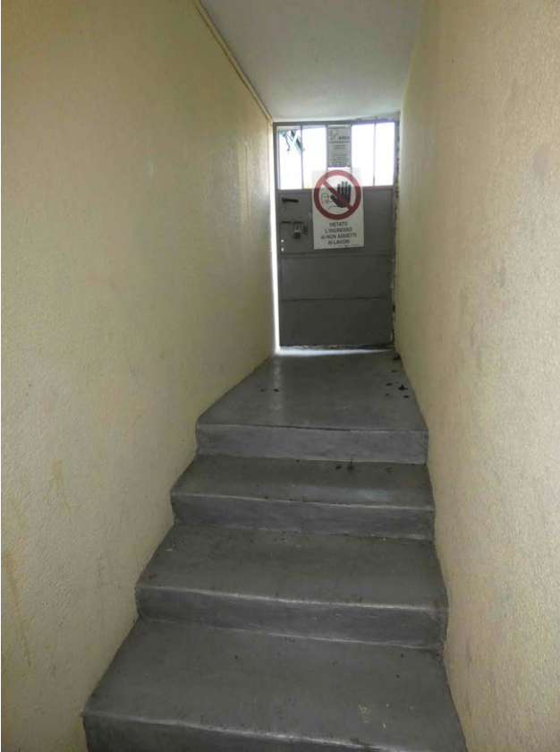
Foto 10. Porta d'accesso al terrazzo comune con i solai
