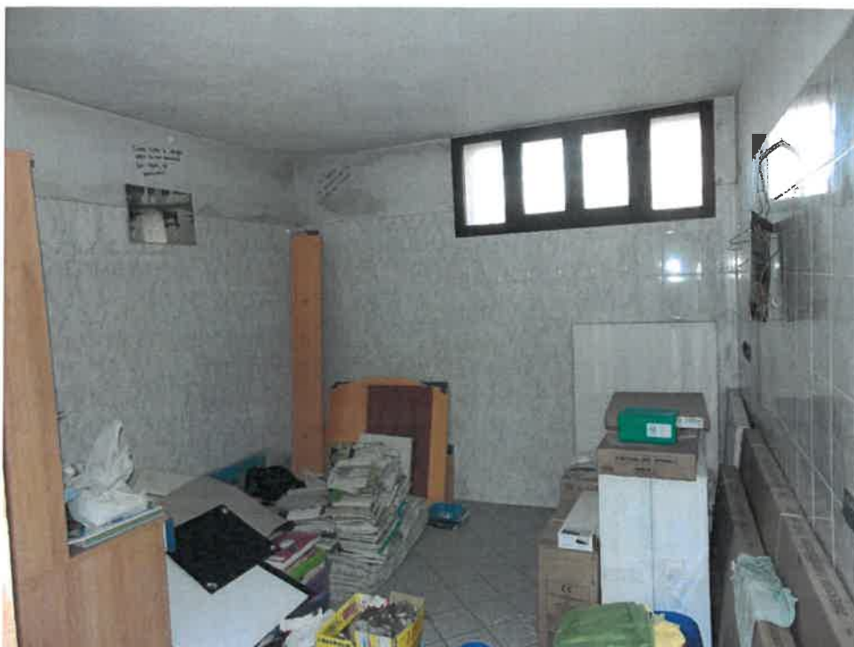
Foto 7: locale predisposto per bagno. Da rimuovere
