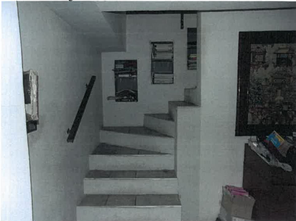
Foto 4: scala di collegamento con piano rialzato, va rimossa e chiuso il foro del solaio
