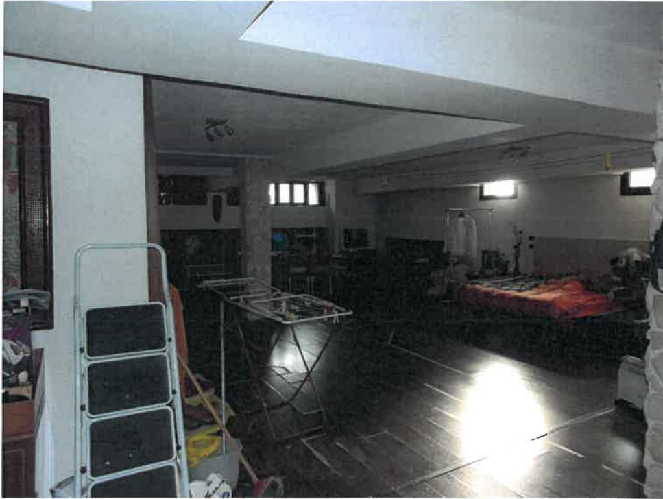
Foto 11: locale principale con zona pranzo, non idonea alla destinazione d'uso
