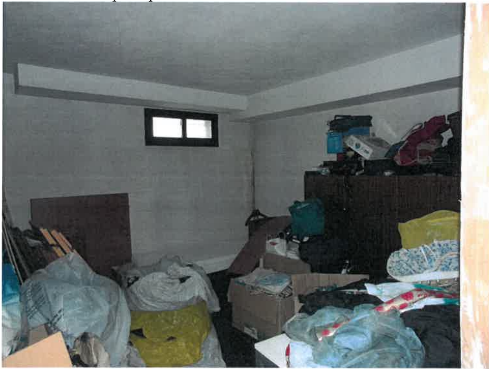
Foto 6: locale realizzato abusivamente. Nell'angolo umidità da infiltrazione
