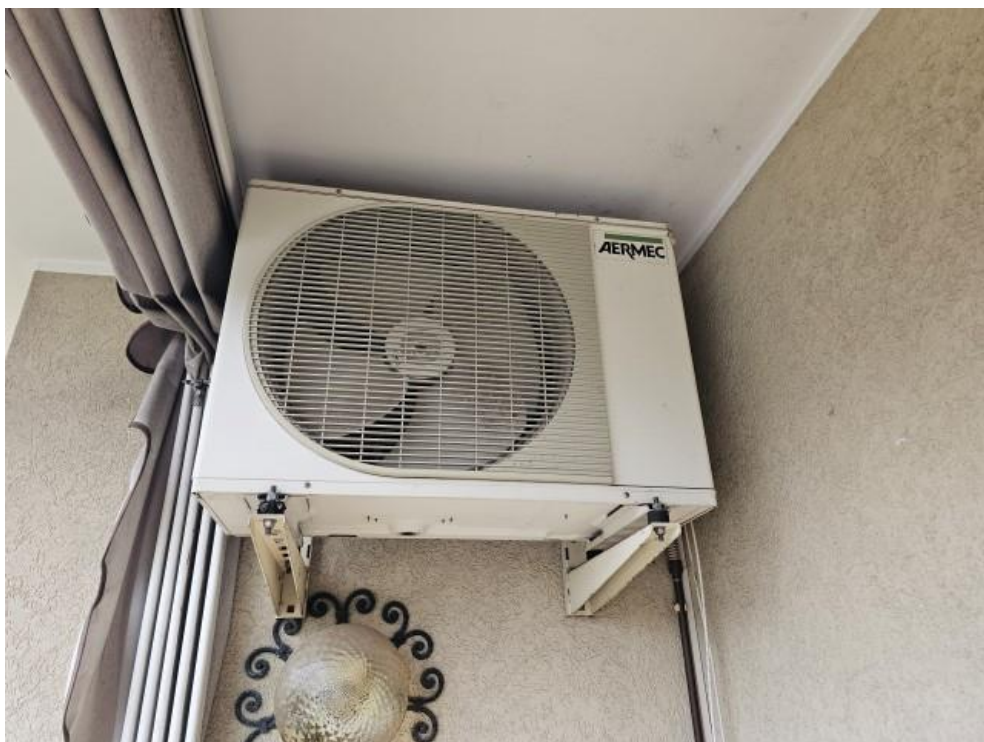
FOTO 22: UNITA' ESTERNA CLIMATIZZATORE (SUB. 10 – 1°P.)
