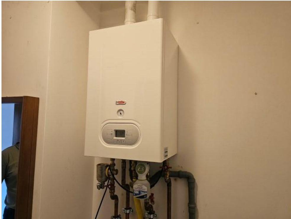
FOTO 19: CALDAIA (SUB. 10 – 1°P.)
