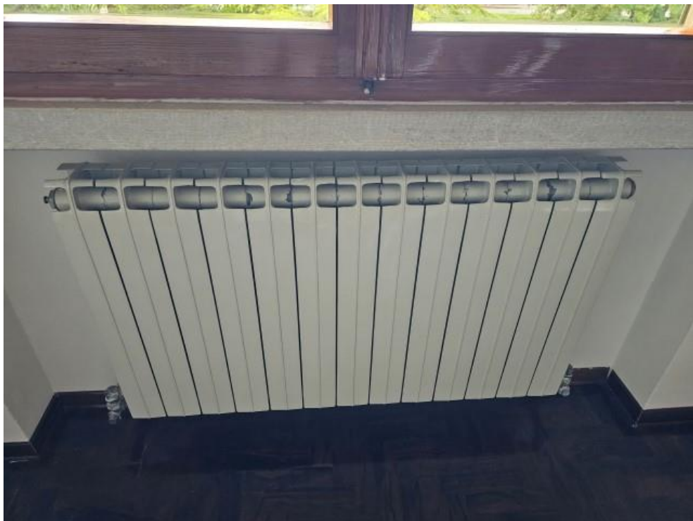
FOTO 20: PARTICOLARE TERMOSIFONE (SUB. 10 – 1°P.)
