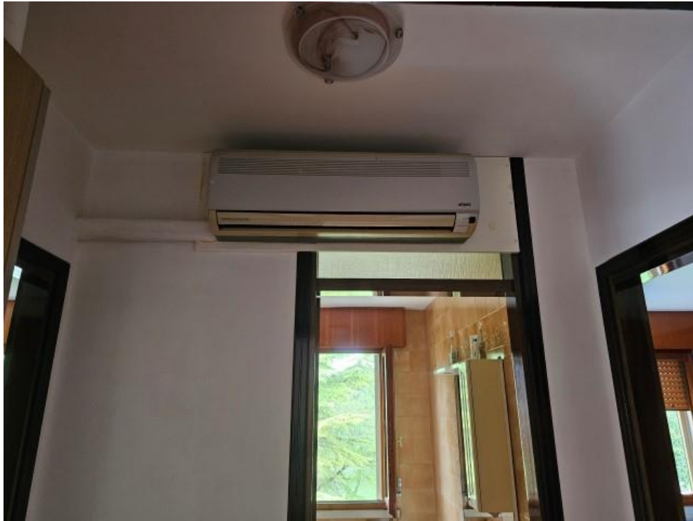
FOTO 23: UNITA' INTERNA CLIMATIZZATORE (SUB. 10 – 1°P.)
