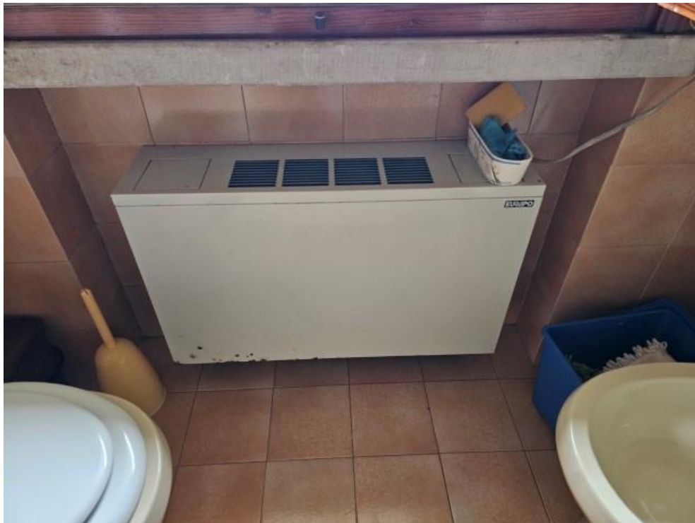
FOTO 21: PARTICOLARE VENTILCONVETTORE (SUB. 10 – 1°P.)
