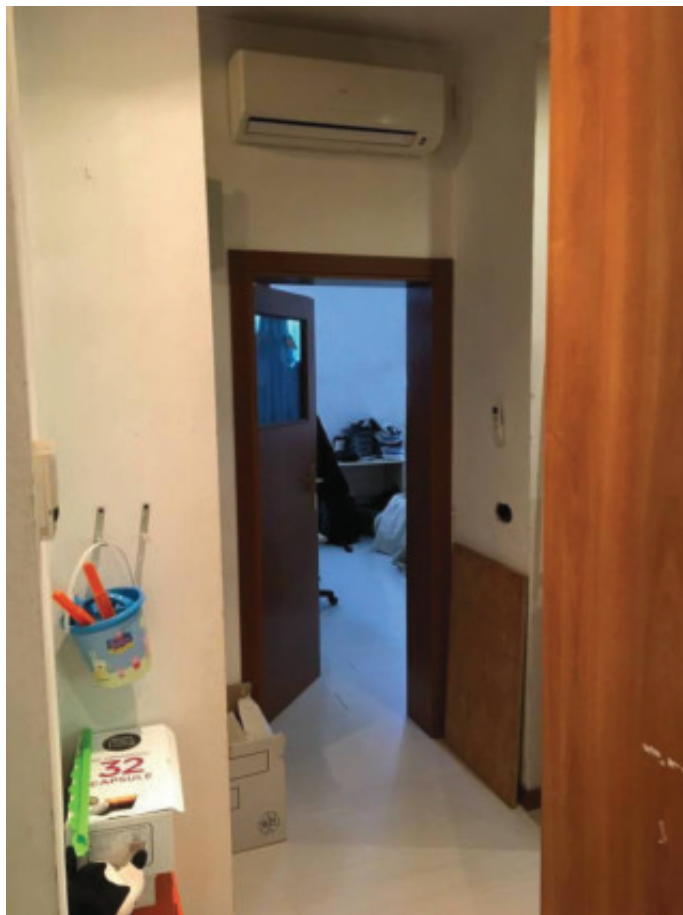
Foto n.17: Disimpegno zona notte, difforme da quanto assentito dal Comune (Sub.1).
