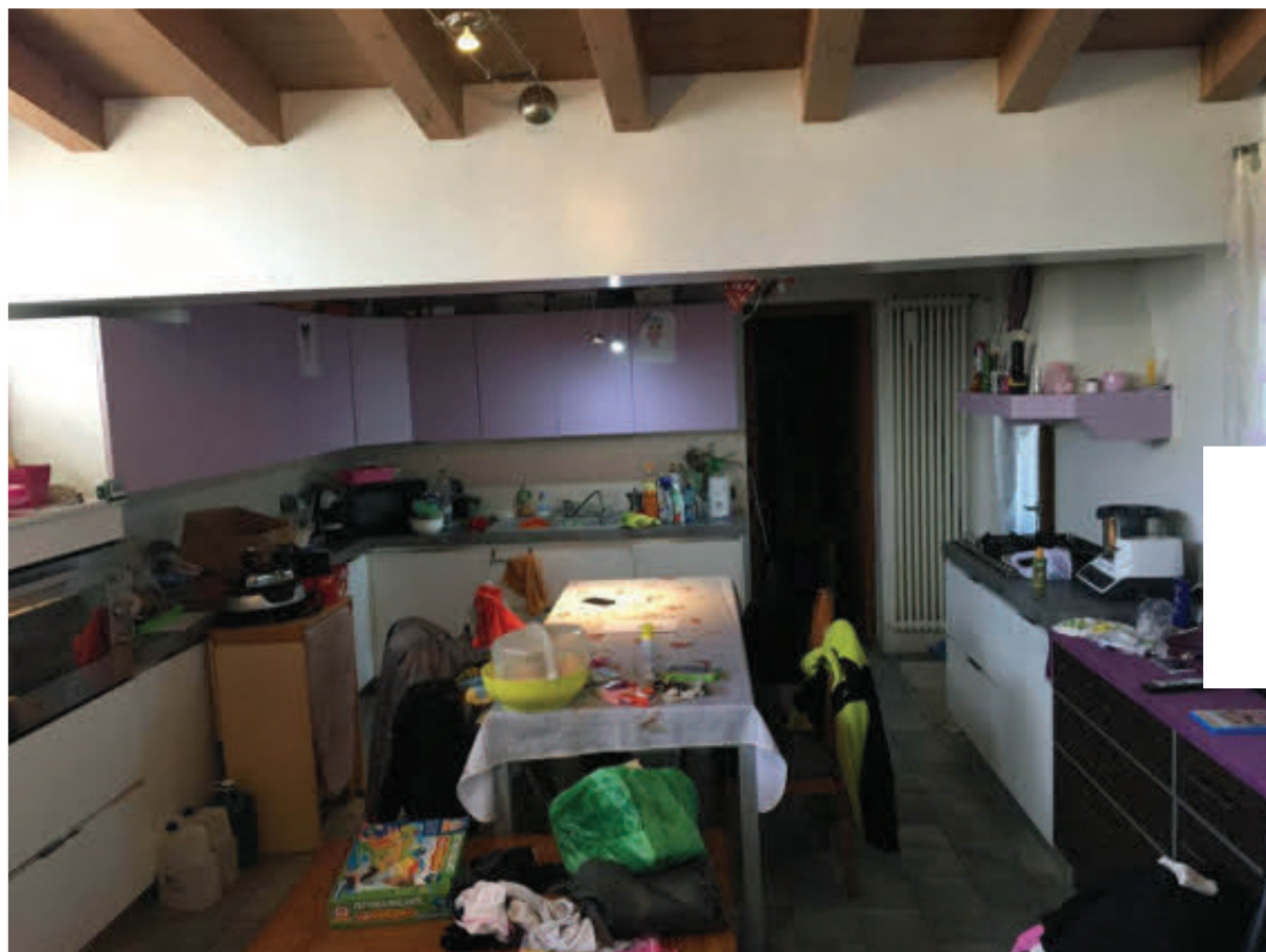
Foto n.12: Pranzo/Cucina, realizzato abusivamente accorpendo l'ex autorimessa (Sub.5) con parte della corte esclusiva (Sub.7).
