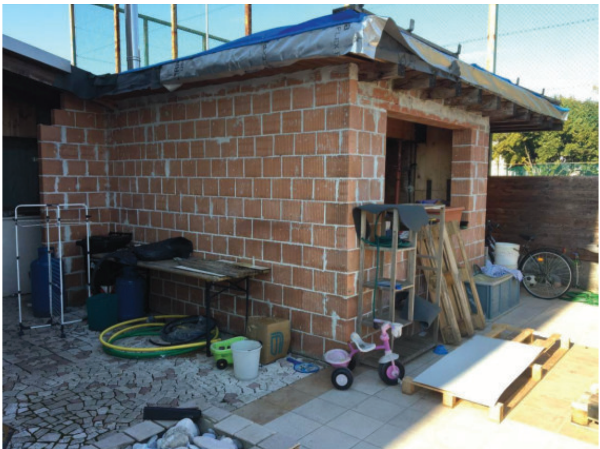
Foto n.22: Facciata Sud ed Est della parte accessoria adibita a Lavanderia-Deposito che è stata edificata, abusivamente, in luogo di un pergolato, sullo scoperto esclusivo (Sub.7).
