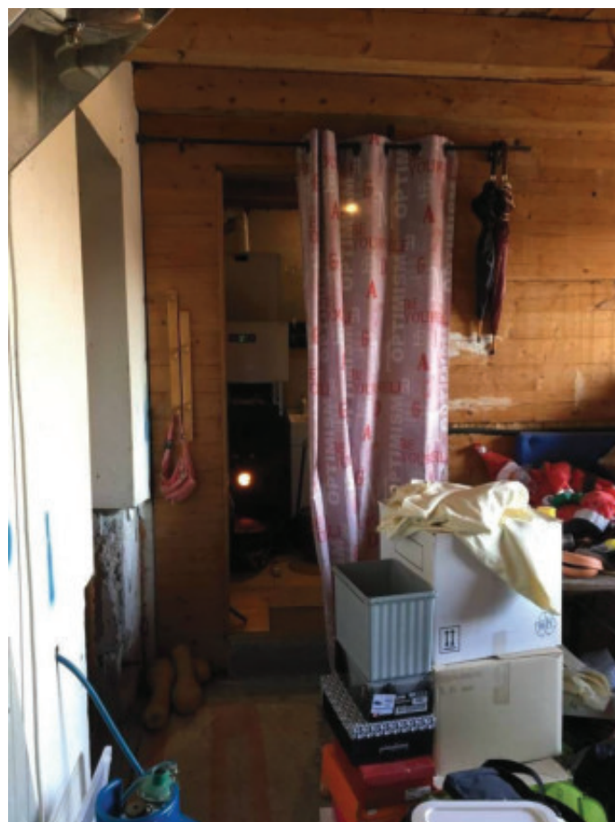
Foto n.24: Deposito con vista della porta d'ingresso della Lavanderia/C.T.; il tutto realizzato abusivamente, in luogo di un pergolato, sopra lo scoperto esclusivo (Sub.7).
