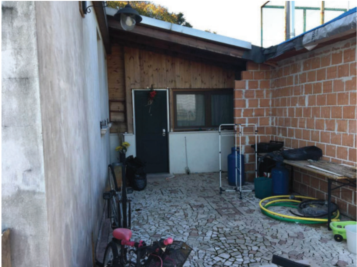
Foto n.9: Ampliamento abusivo (da completare) con evidenza del nuovo portoncino d'ingresso posto ad est della zona giorno dell'Appartamento oggetto di E.I. (Sub.1) e direttamente collegato con la restante Corte Scoperta Esclusiva (Sub.7).
