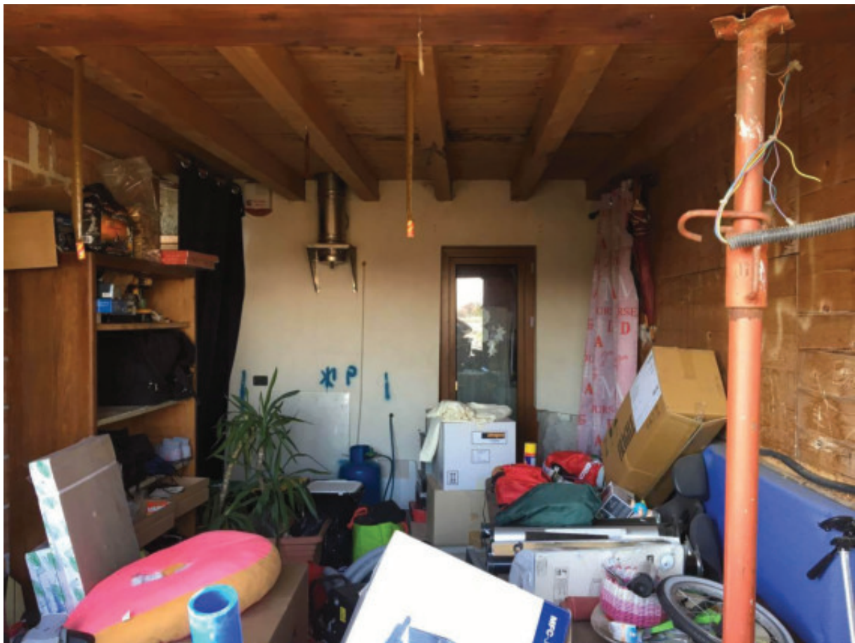
Foto n.23: Deposito abusivo che era stato autorizzato come Pergolato.
