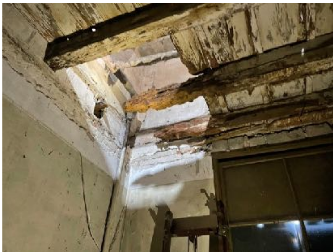
Particolare solai ammalati piano secondo
