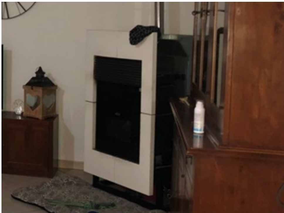
Termo camino nella sala p.t per riscaldamento
