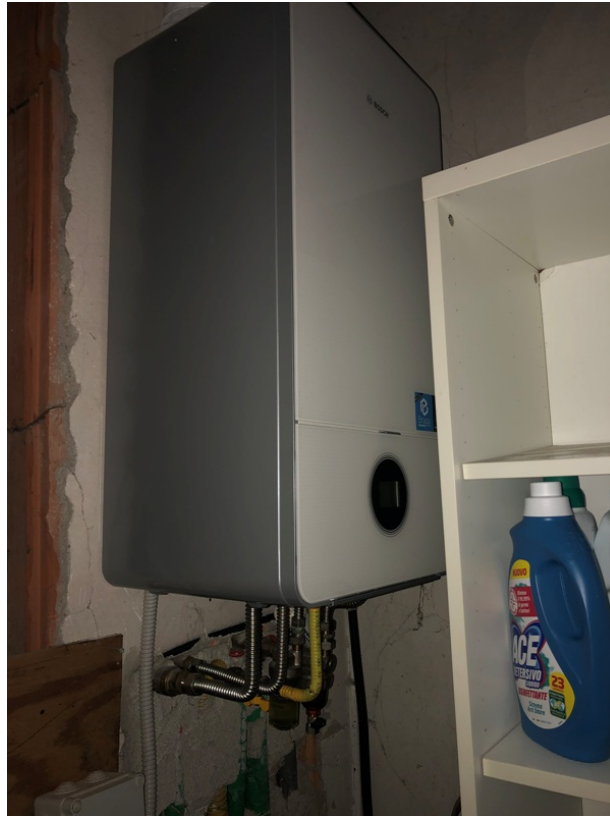
Caldaia per produzione acqua calda sanitaria
