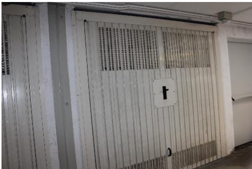
FOTO 27: TREZZANO S/N (MI), VIA MORONA 10, box sub. 132
