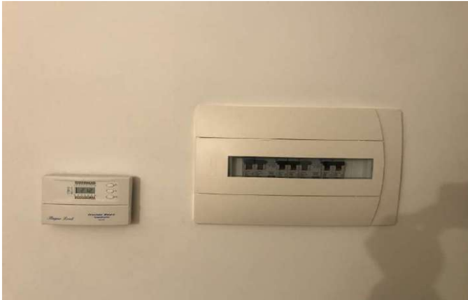
Foto n. 19: dettaglio quadro elettrico e termostato.
