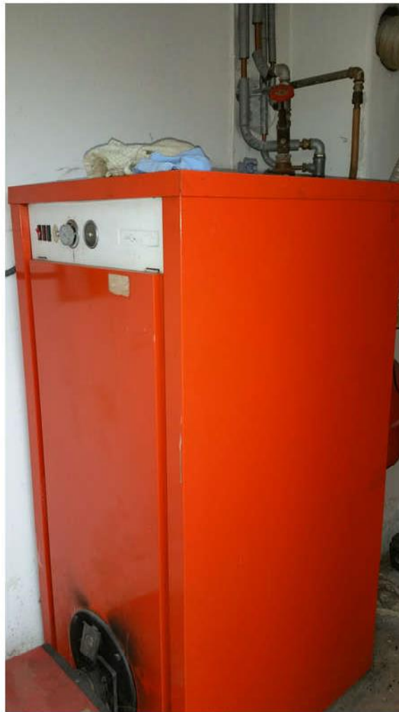
19-Lotto 2 - caldaia gasolio 1
