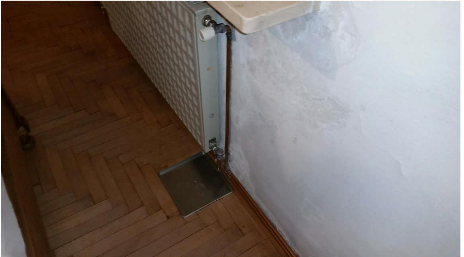
22-Lotto 2 - particolare riscaldamento
