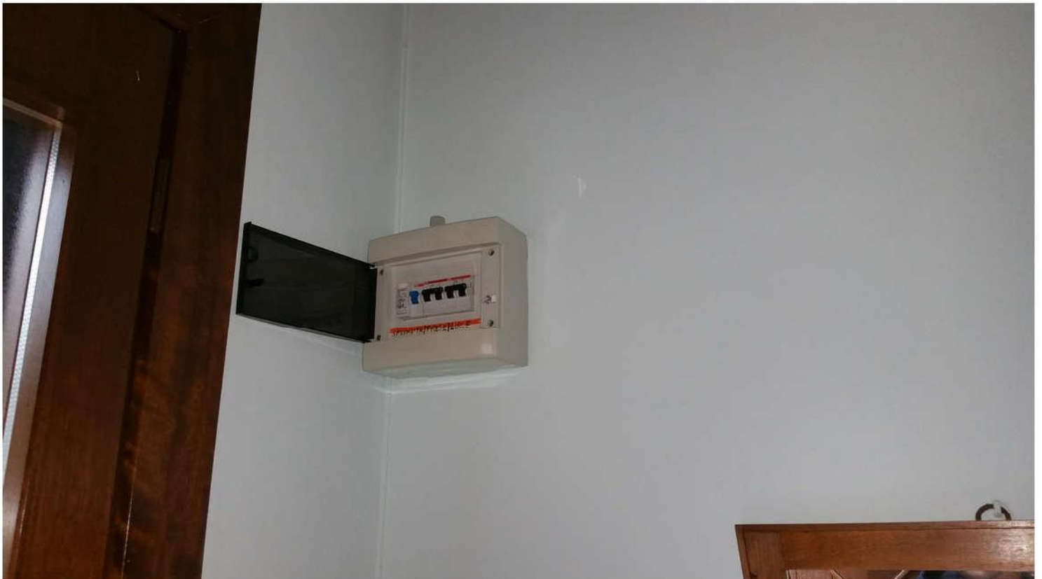
24-Lotto 2 - quadro elettrico
