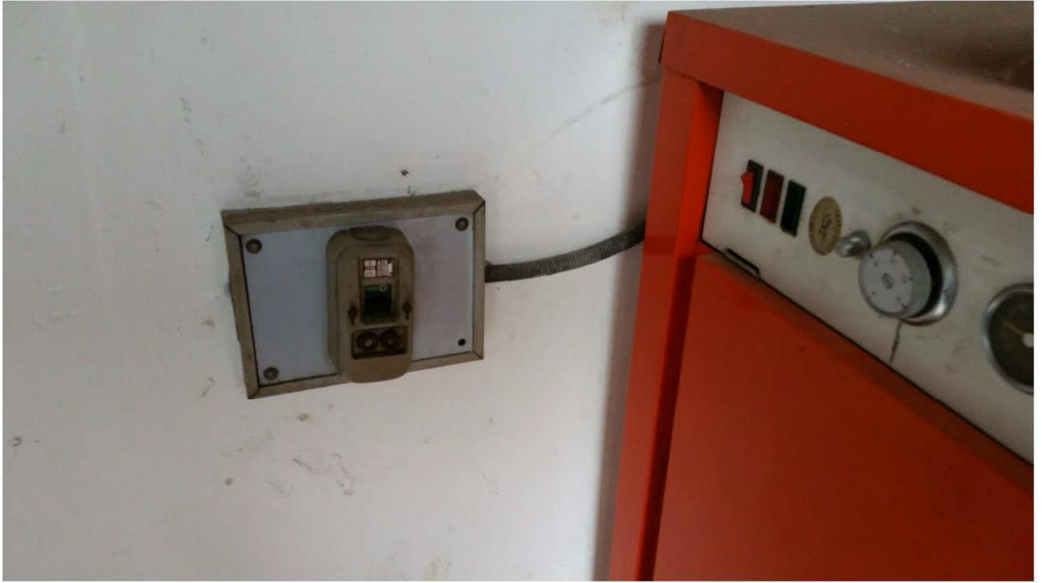
21-Lotto 2 - particolare imp elettrico caldaia
