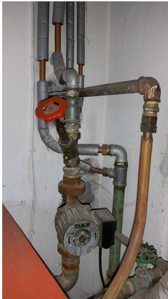
23-Lotto 2 - pompa caldaia
