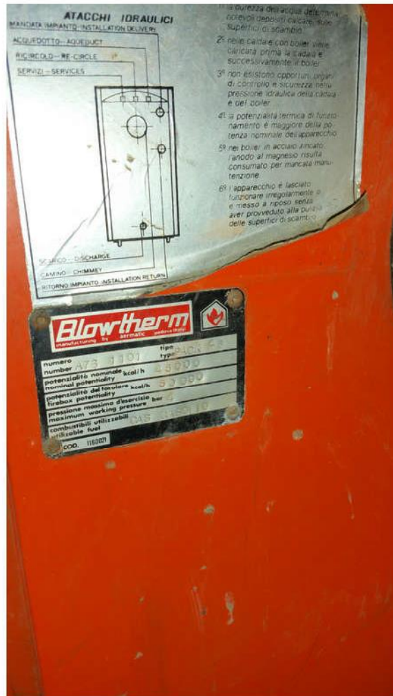
20-Lotto 2 - caldaia gasolio 2
