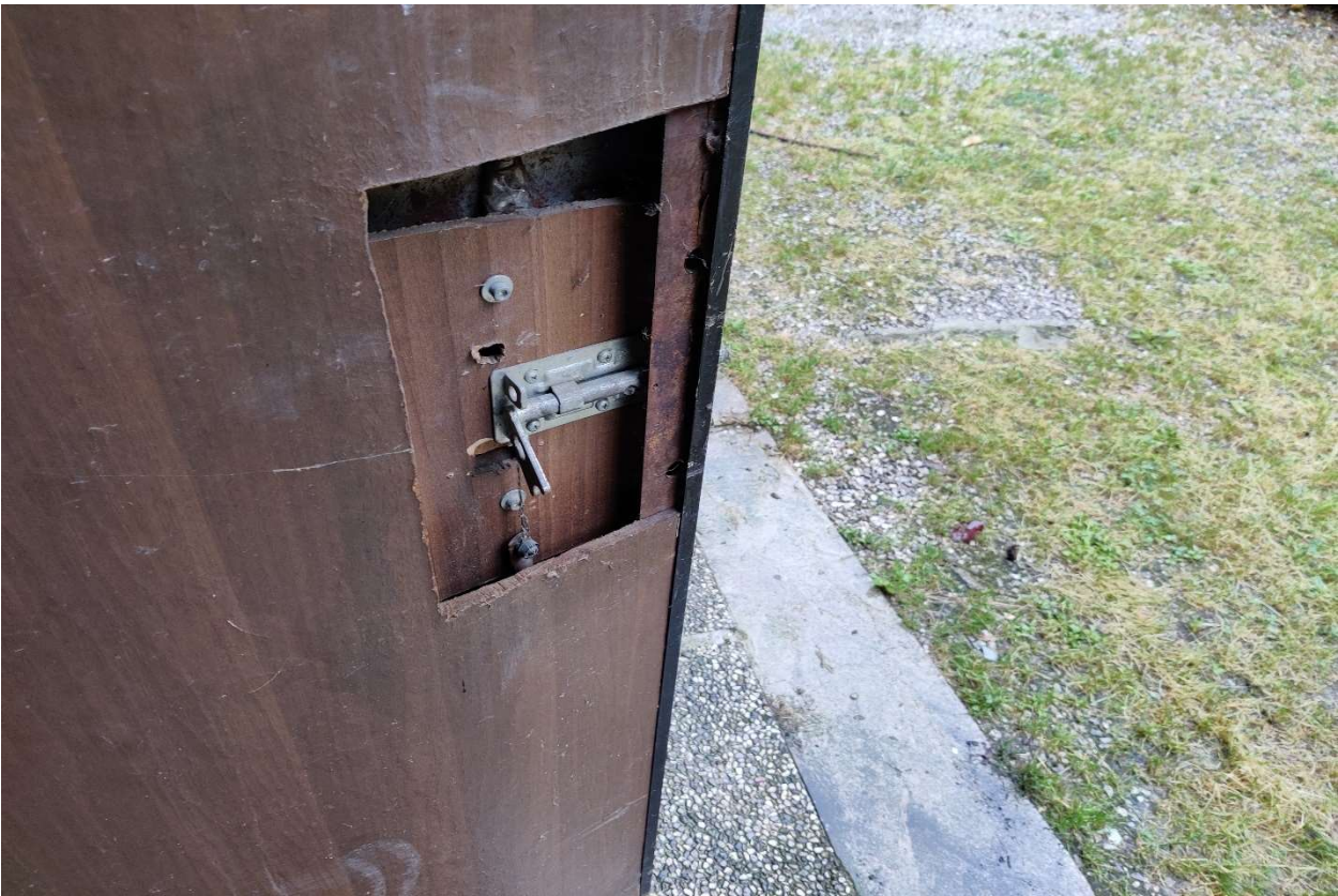
Foto n. 24 – Riparazioni non razionali ed antiestetiche.
