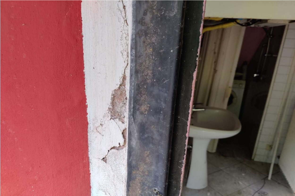
Foto n. 25 – Degrado alla parte muraria esterna.
