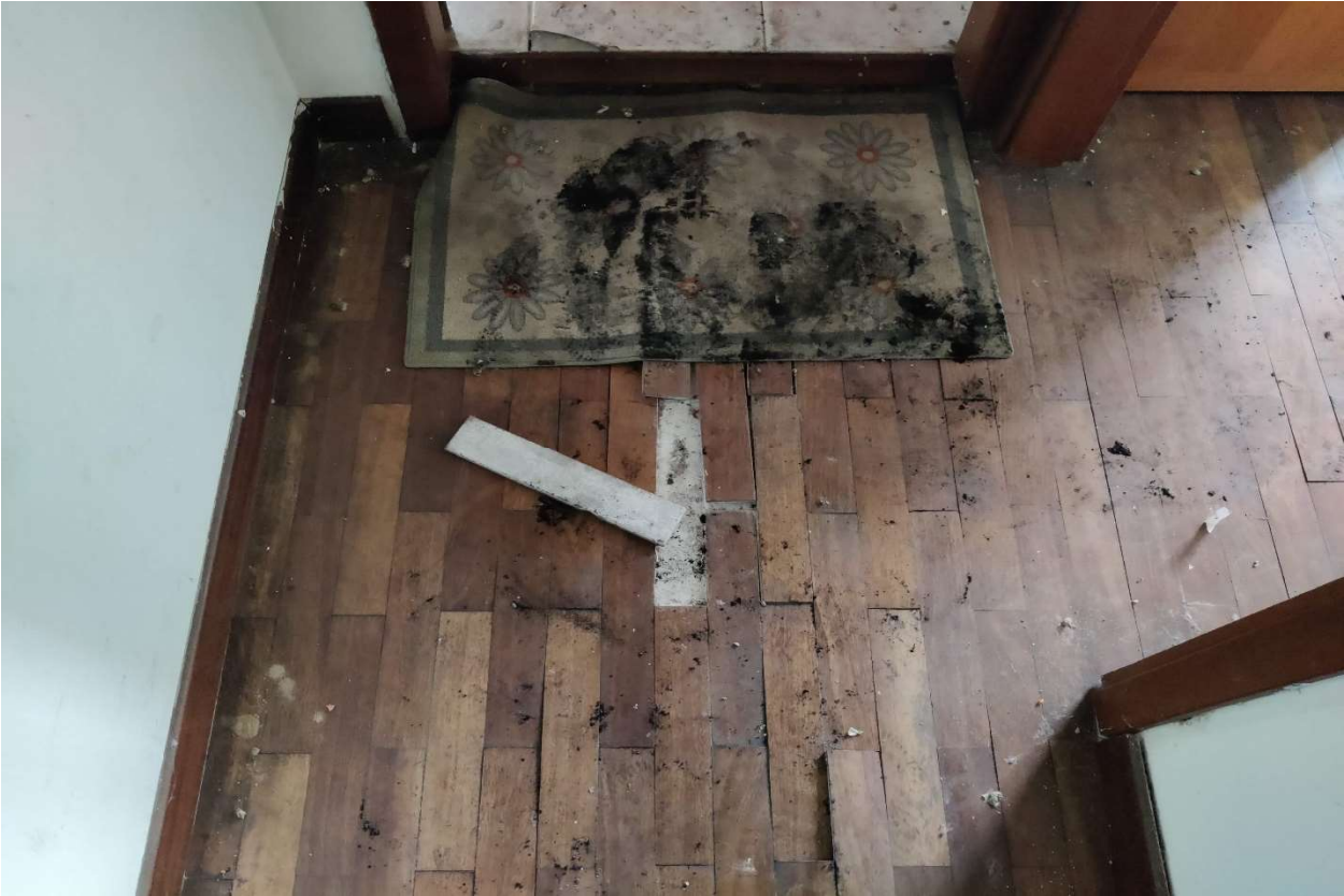
Foto n. 21 – Degrado generale alla pavimentazione.
