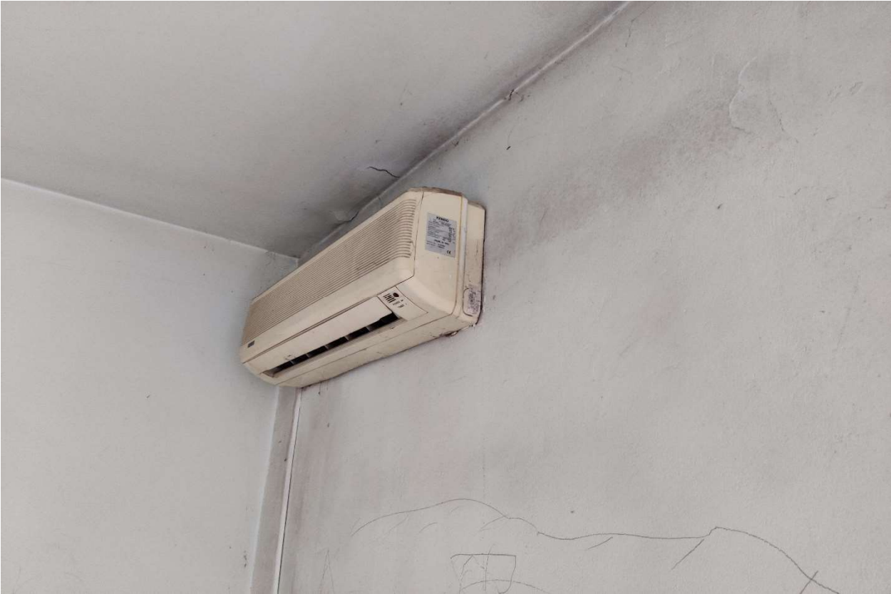
Foto n. 19 – Split interno climatizzazione.
