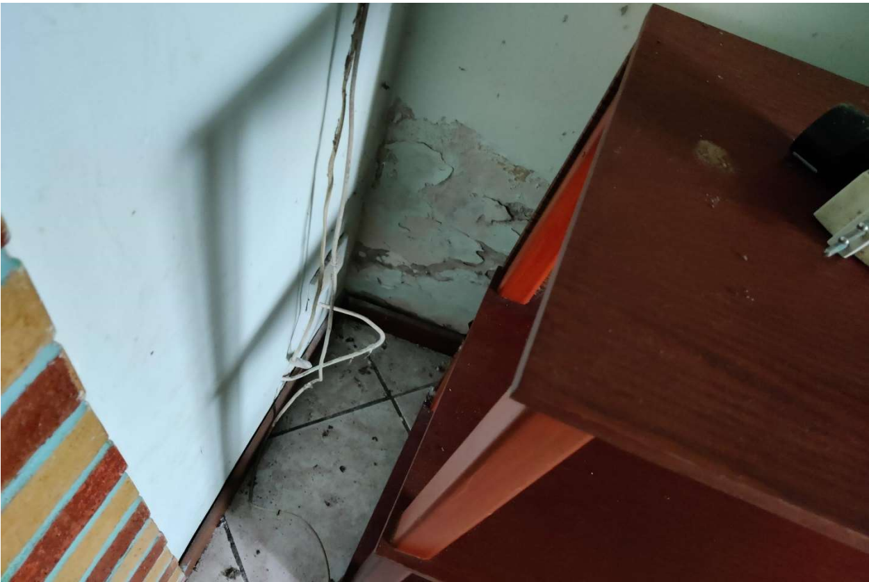
Foto n. 22 – Degrado generale alla parte muraria.
