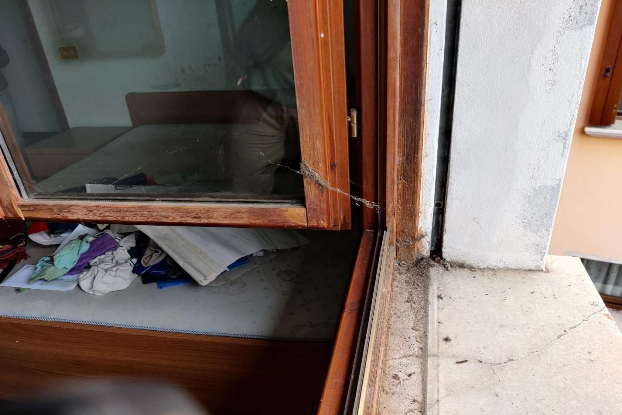
Foto n. 23 – Degrado generale ai serramenti.
