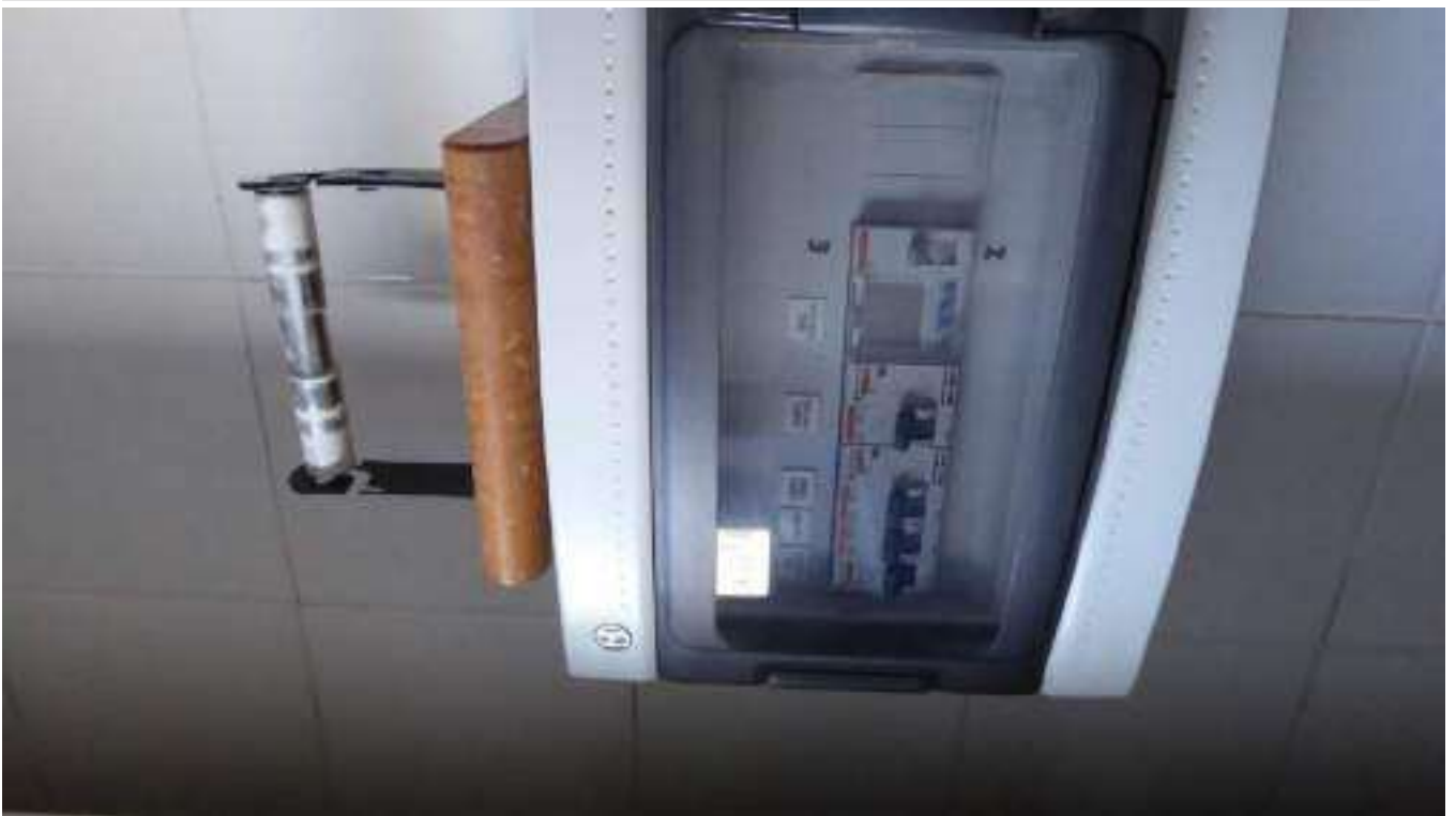
Foto n. 21 – vista quadro generale elettrico
