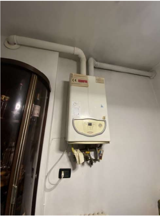
FOTO 13: Caldaia ubicata in cucina
