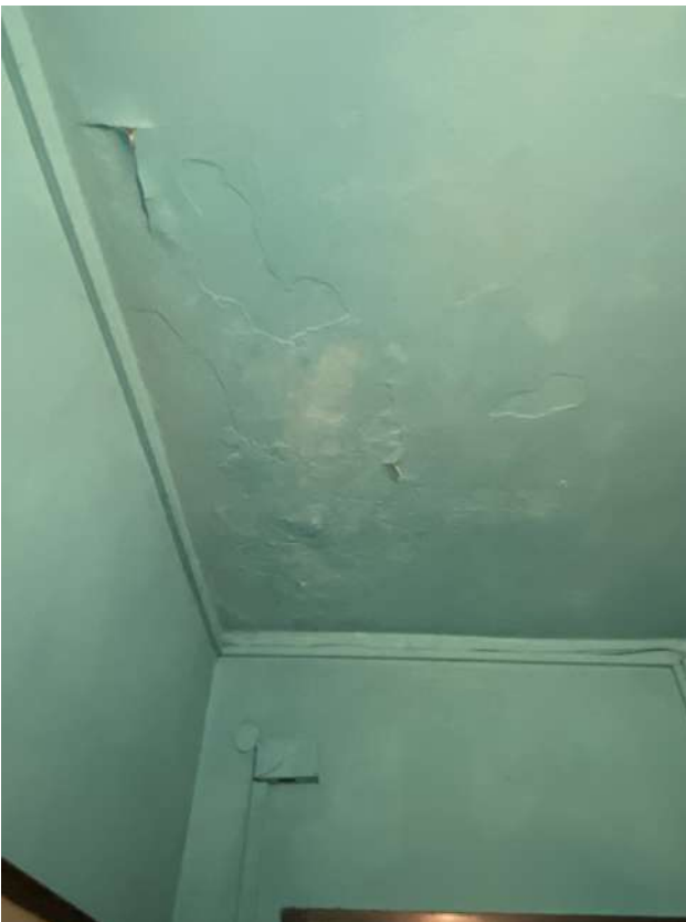
FOTO 8: Evidenti problemi di infiltrazioni/umidità
