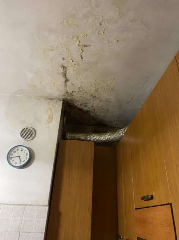
FOTO 15: Infiltrazioni e muffa in cucina
