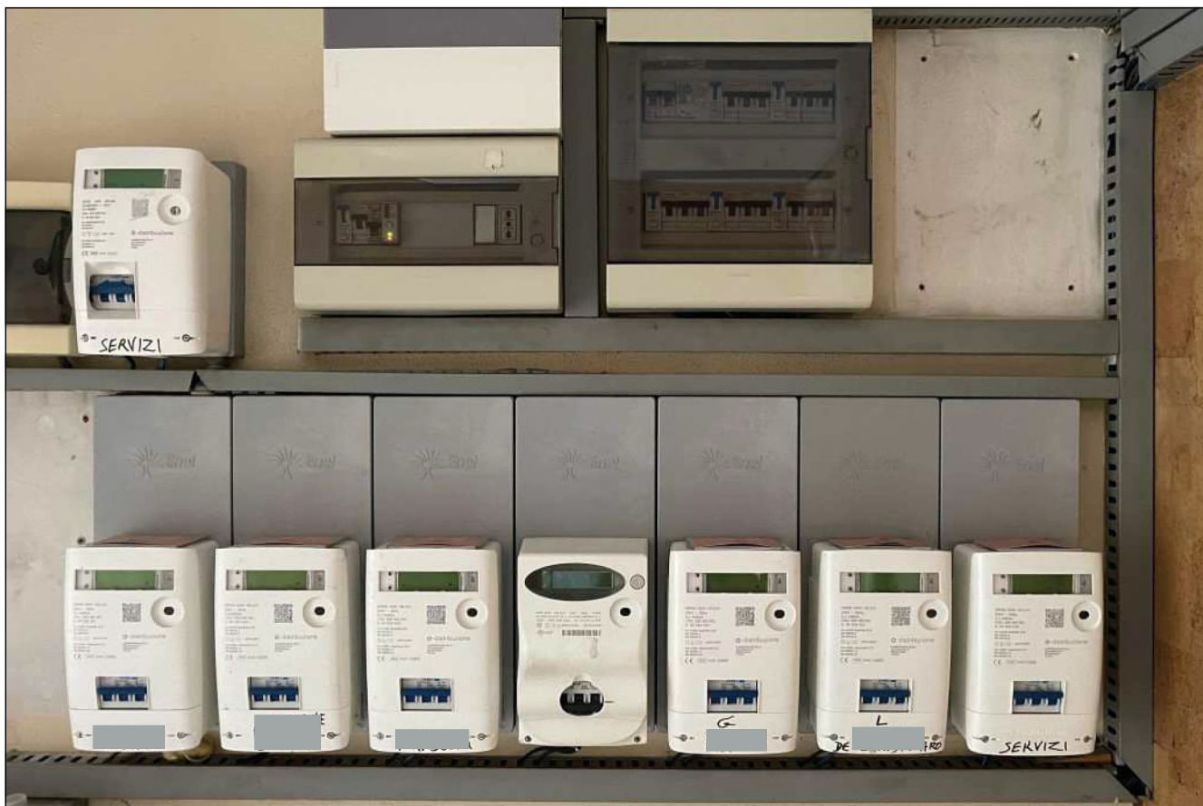
Foto n. 20) Vista dei contatori Enel
