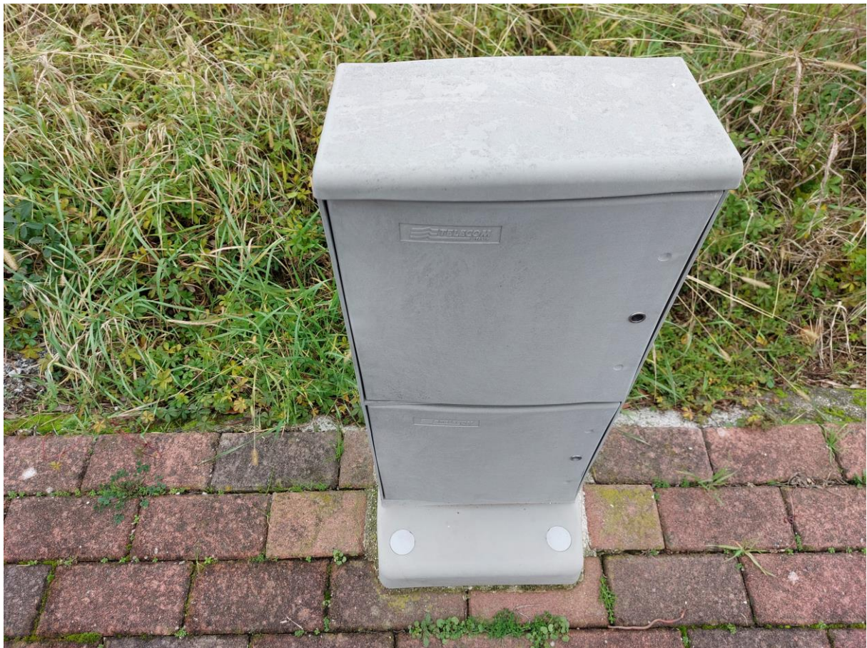
Foto n° 2 - Lotto 5 - Comune di San Michele al Tagliamento (VE) - Frazione Cesarolo - Foglio 38 m.le 949 - Particolare di uno degli armadietti per utenze di telecomunicazione presenti in prossimità dei terreni pignorati, nell'ambito dal Piano di Lottizzazione "Via G. Forgiarini".
