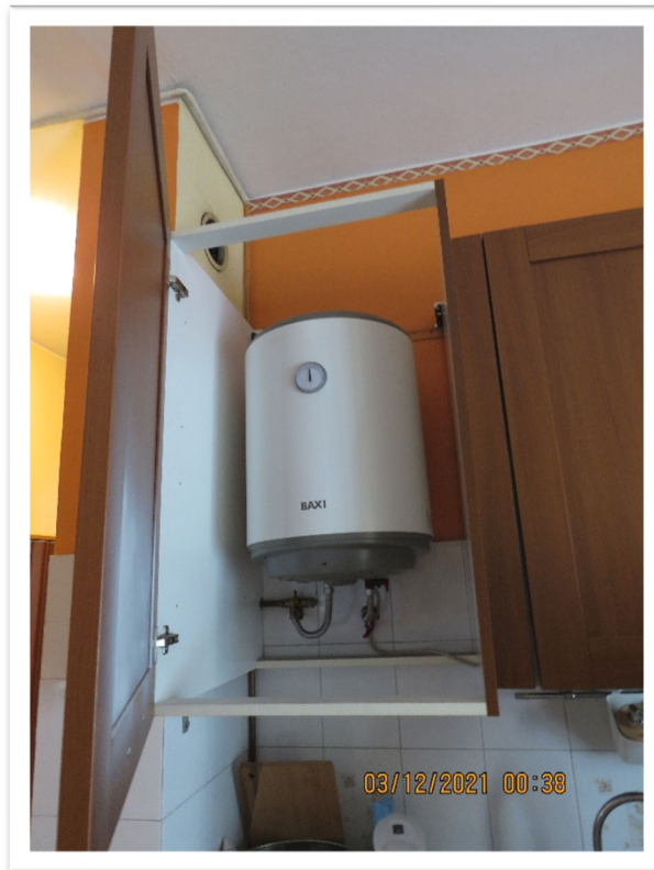
Il boiler e particolare di un termosifone.
