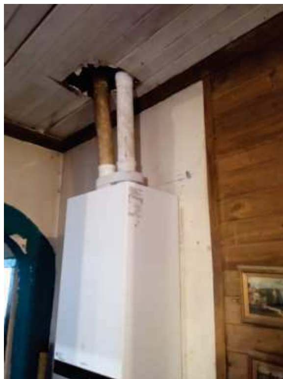
Interno – Foto 19_Caldaia
