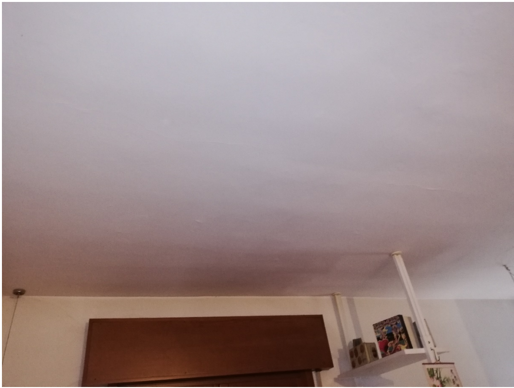
Foto n. 15: particolare soffitto del soggiorno
