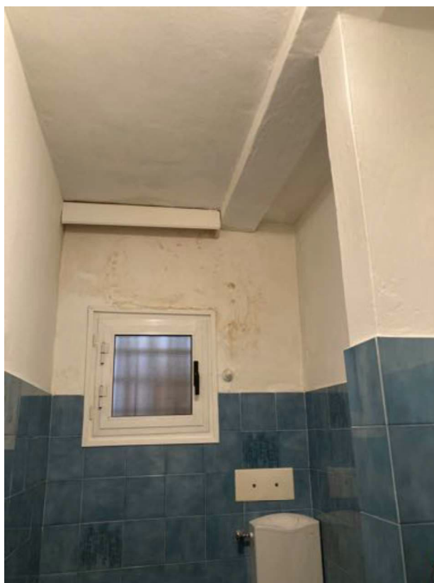
FOTO 6 - Il bagno. Si notano i segni infiltrativi.
