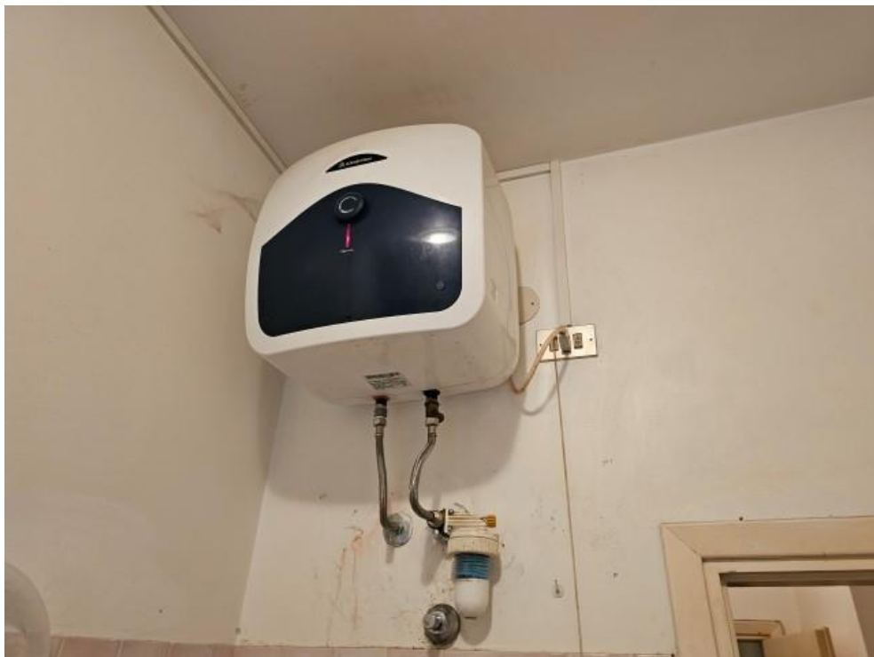
FOTO 20: BOILER ELETTRICO (SUB. 32 – 4°P.)
