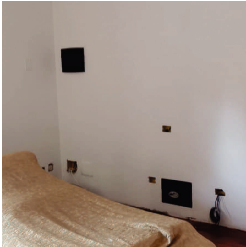
Stato impianto elettrico
