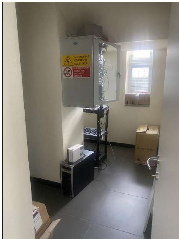
SOTTOSCALA LOCALE QUADRO ELETTRICO - VISTA FOTOGRAFICA 13)
