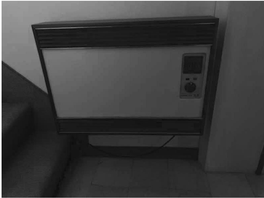
Foto 41: Lotto 2- Sistema di riscaldamento con radiatore Warmplan XX.
