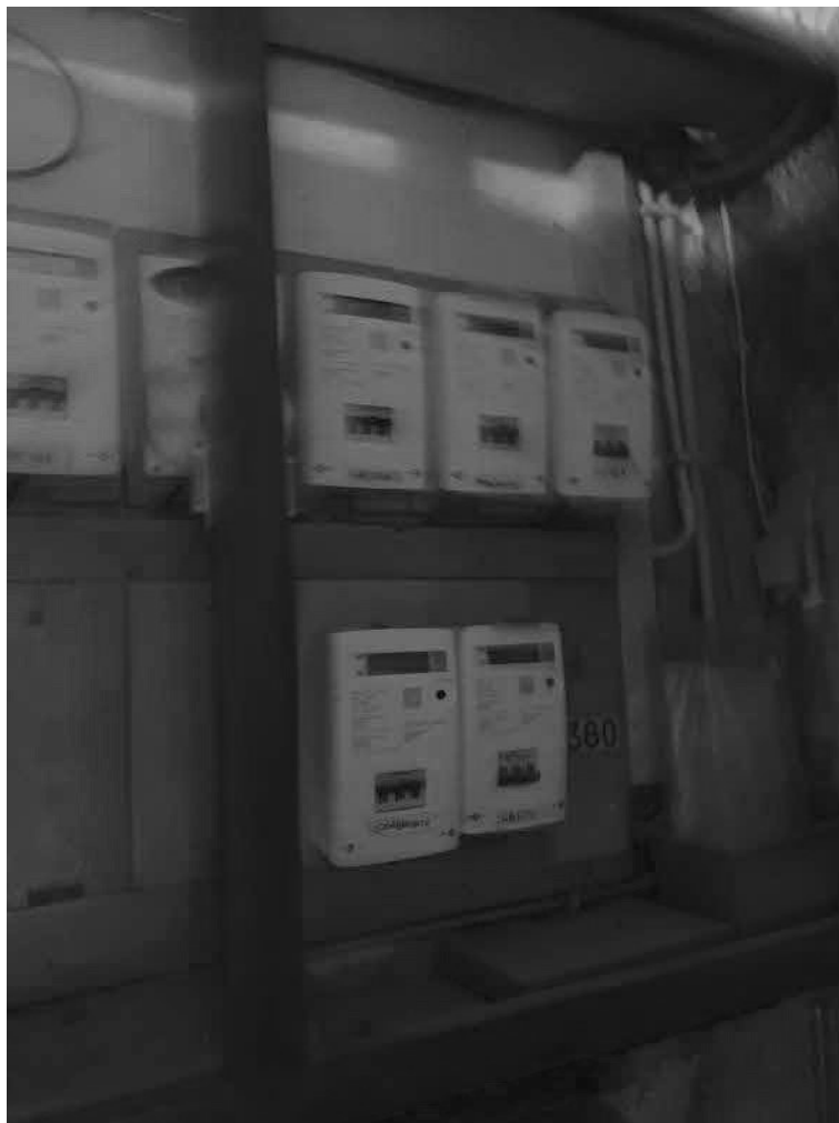
Foto 6: Sottoportico Comune al piano terra. Contatori Luce.
