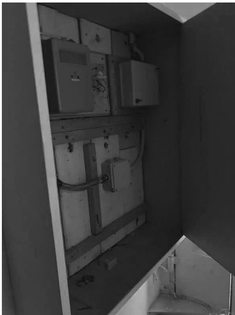
Foto 13: Lotto 1/2- Armadietto impianti (citofono e rele').
