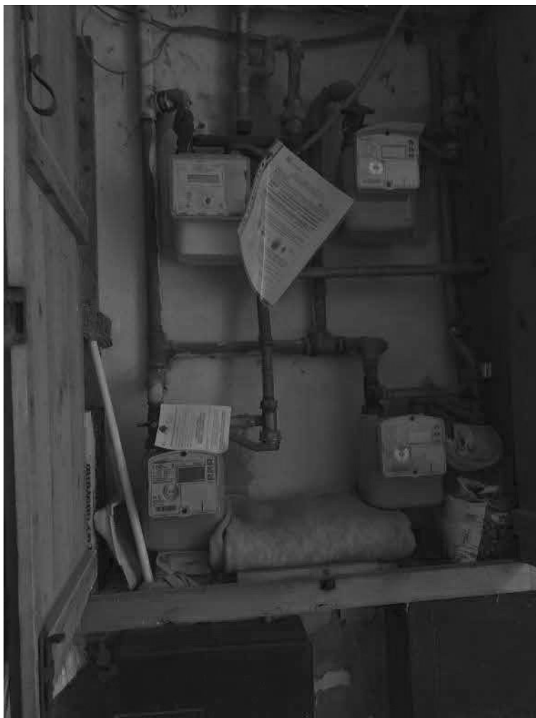
Foto 5: Sottoportico Comune al piano terra. Contatori Gas.
