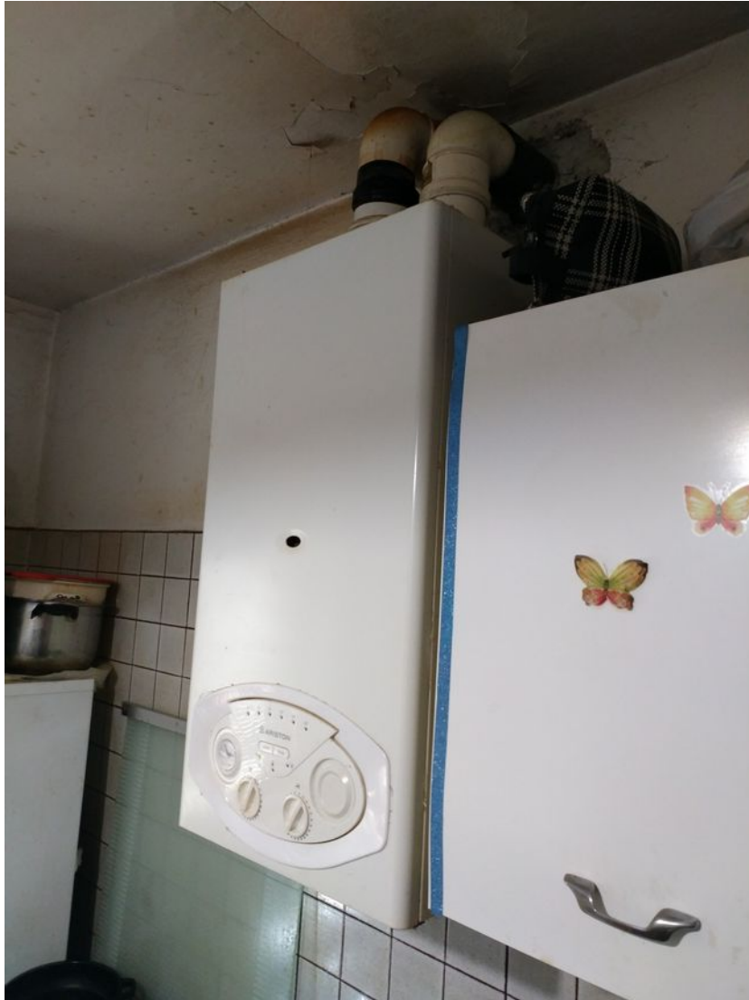
Foto 20 Vista della caldaia.
