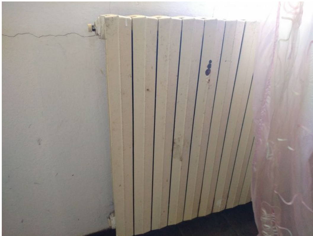
Foto 18 Vista di un radiatore.
