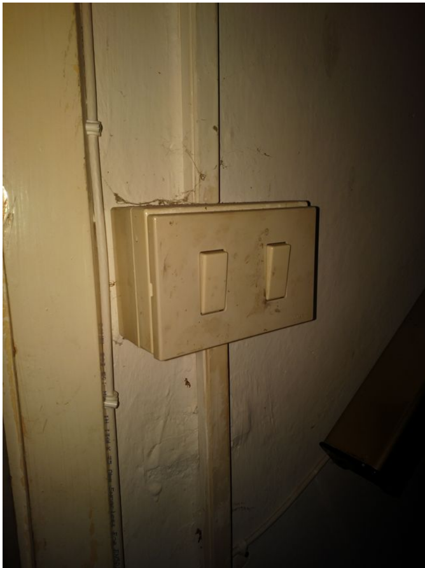
Foto 19 Particolare dell'impianto elettrico.
