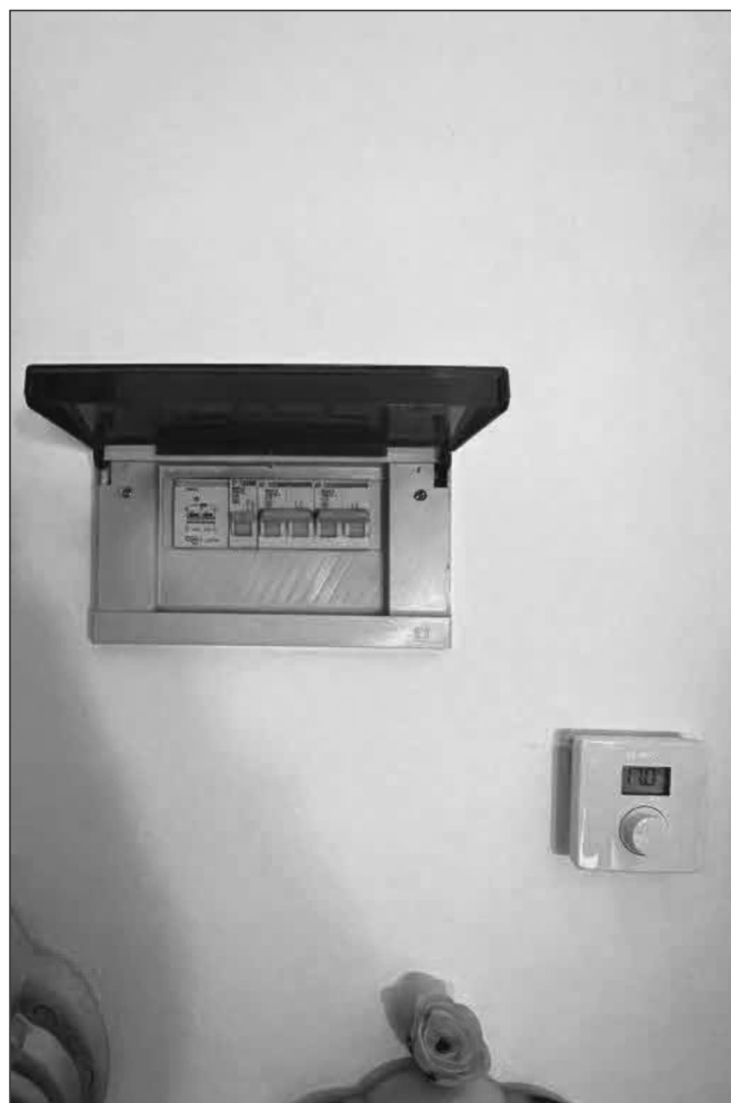
Foto n. 15) veduta del magnetotermico
