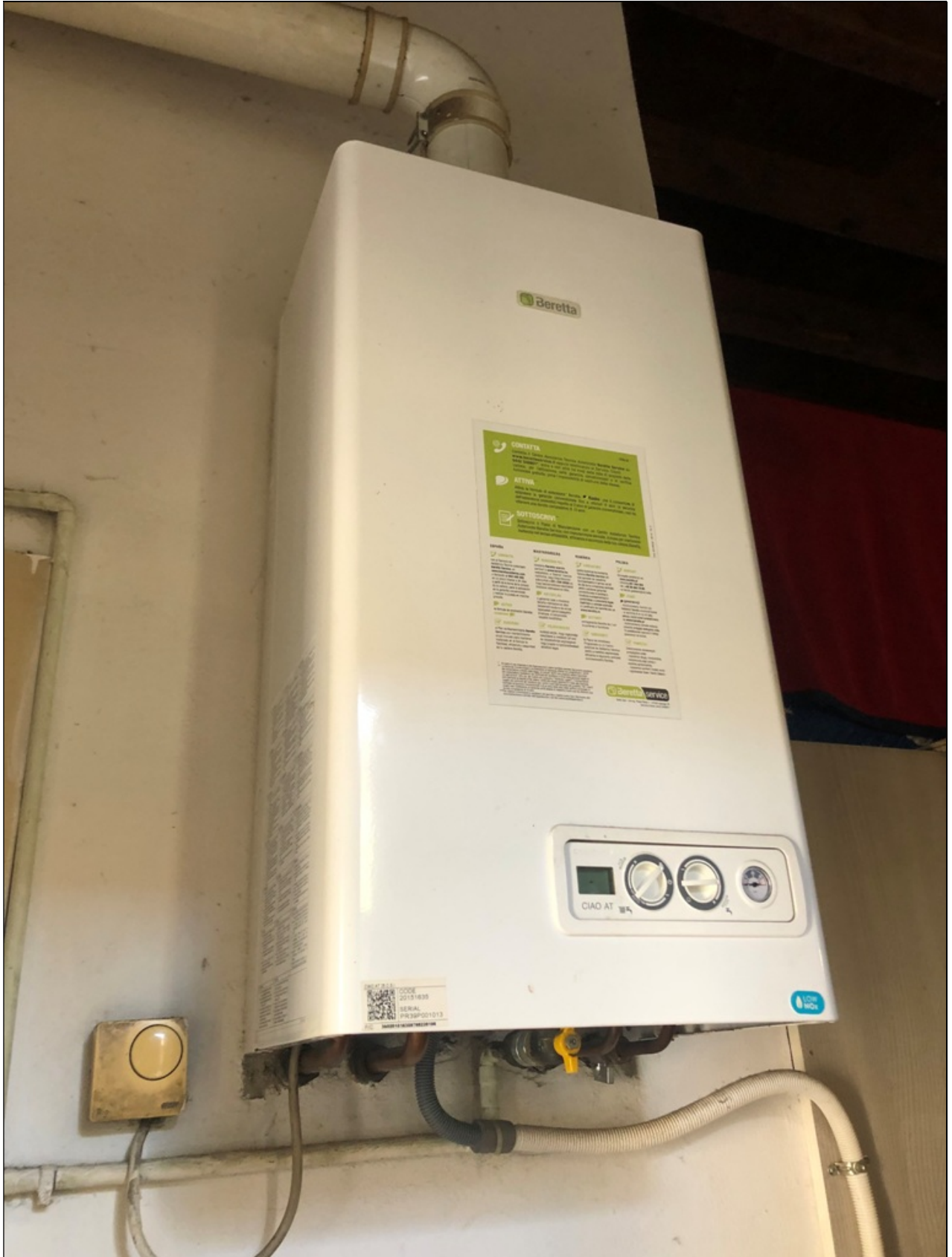
CALDAIA IN INGRESSO
