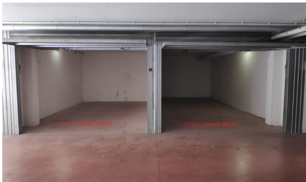
Foto interna garage rispettivamente sub.26 e sub.27
