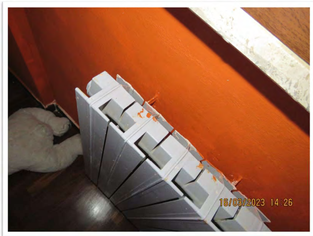
Particolare del termosifone e di traccia di muffe/condensa nella cameretta.
