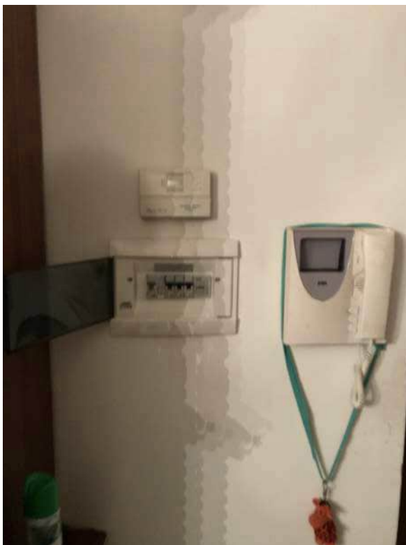
Foto n. 16: dettaglio quadro elettrico e videocitofono.
