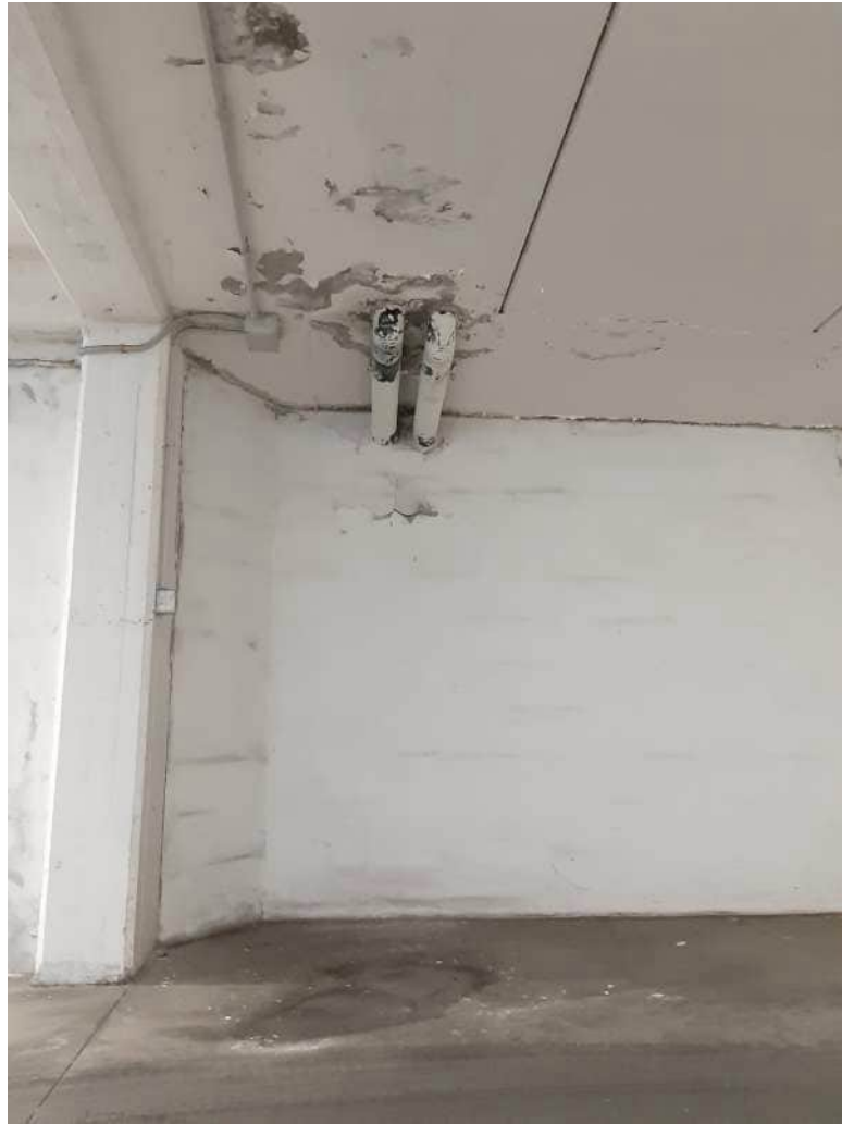
Foto n. 3: vista dei tubi di scarico danneggiati.
