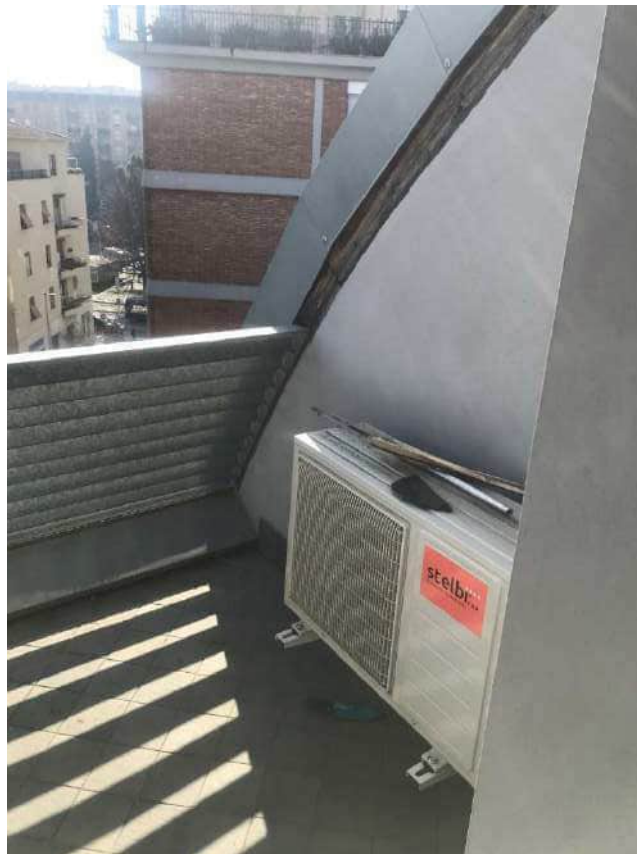
Foto n. 11: vista della loggia- unità esterna impianto condizionamento (soggiorno)
