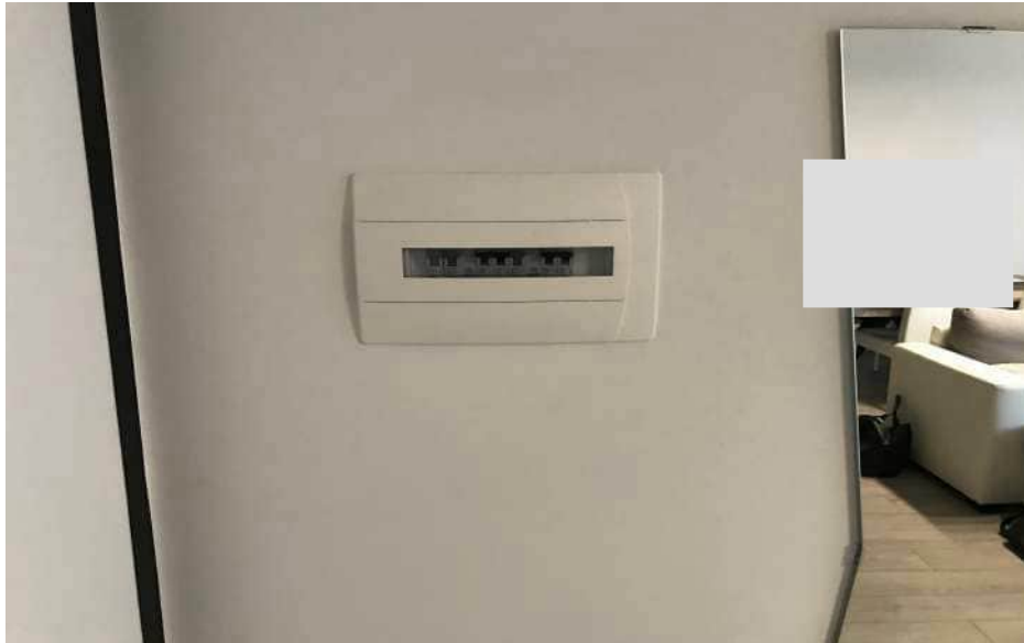
Foto n. 17: dettaglio quadro elettrico.
