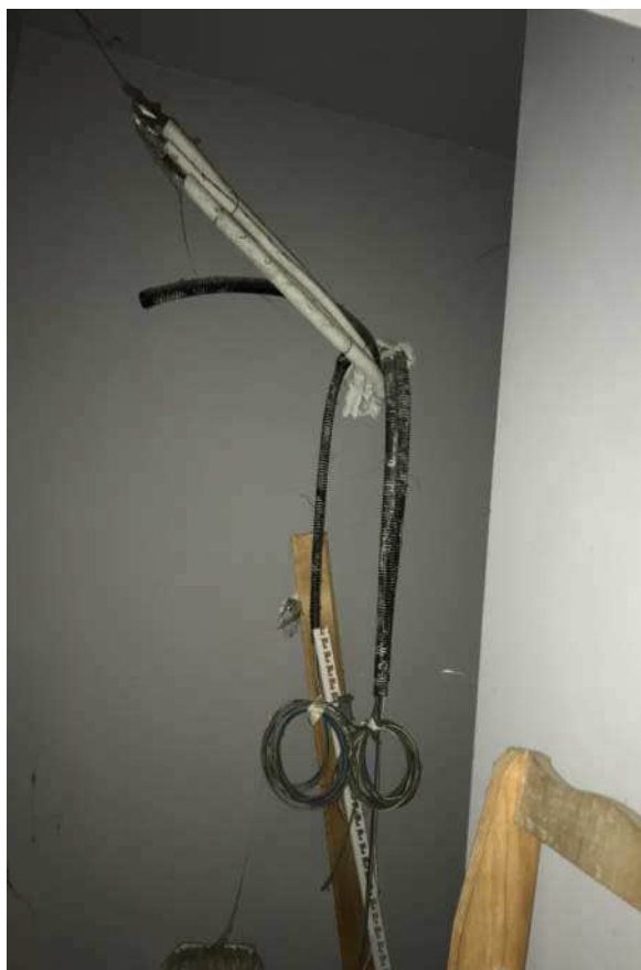
Foto n. 17: dettaglio predisposizione impianto di condizionamento.
