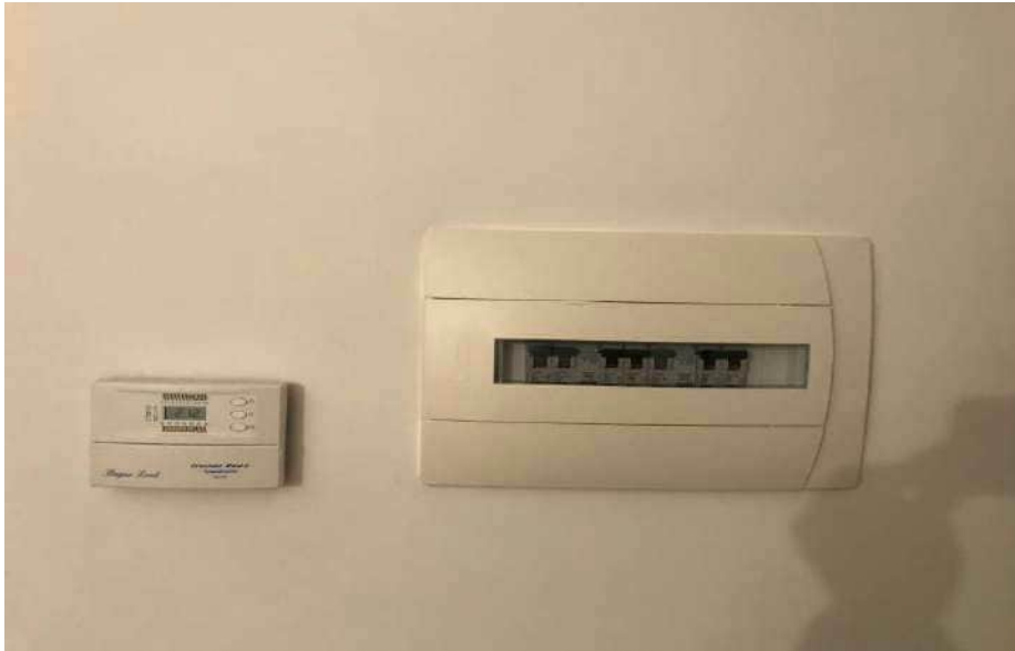
Foto n. 19: dettaglio quadro elettrico e termostato.
