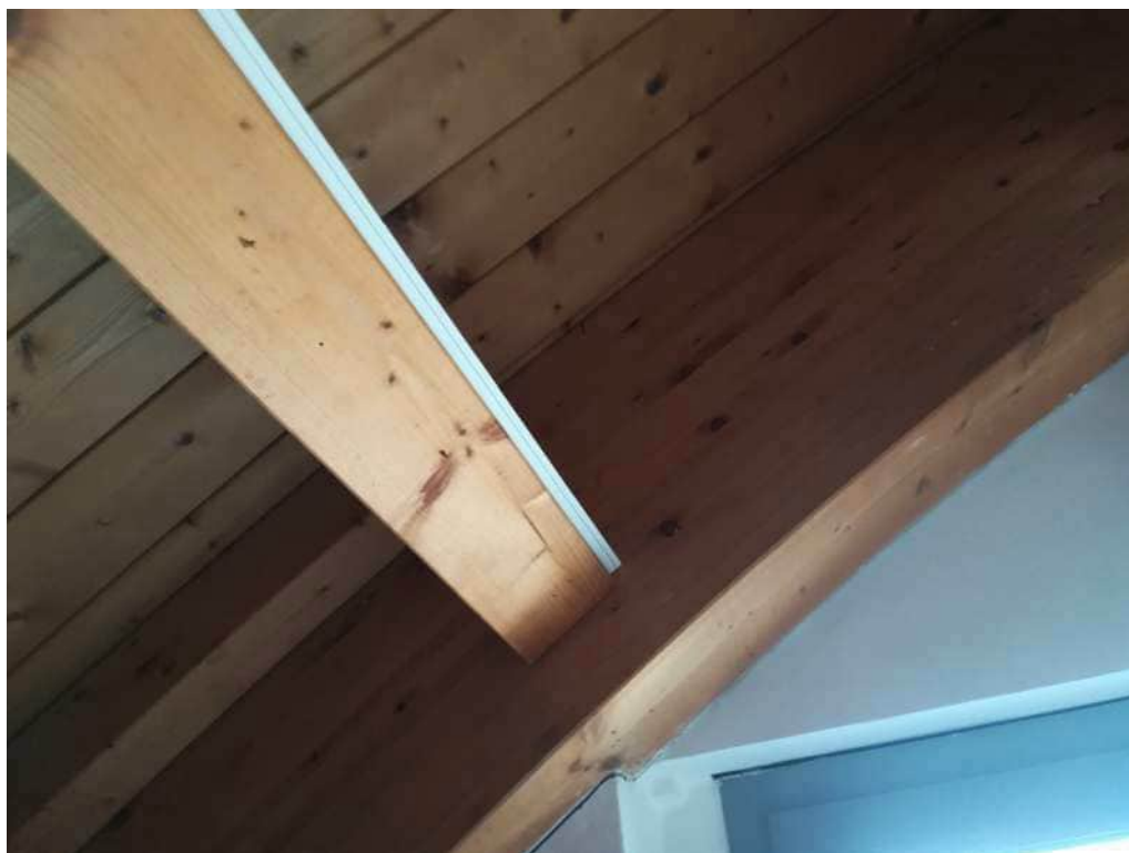
Foto n. 08-09: vista delle macchie di infiltrazioni d'acqua/copertura nella camera da letto.
