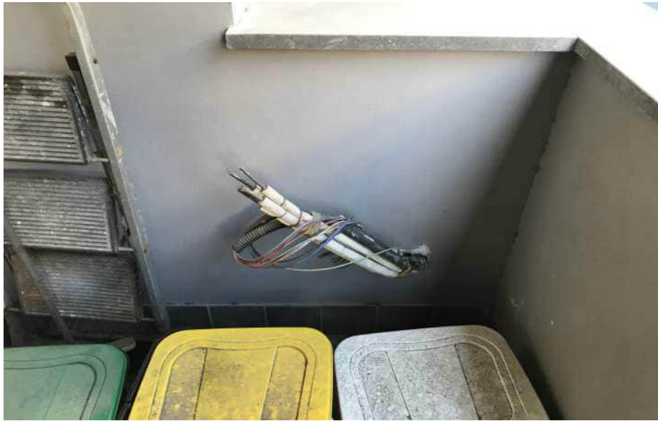
Foto n. 16: dettaglio predisposizione impianto di condizionamento.
