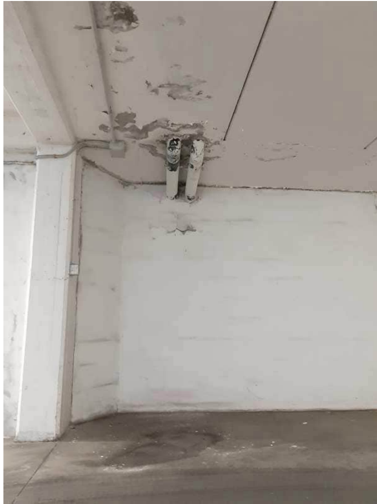
Foto n. 3: vista dei tubi di scarico danneggiati.
