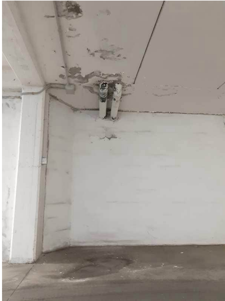
Foto n. 3: vista dei tubi di scarico danneggiati.
