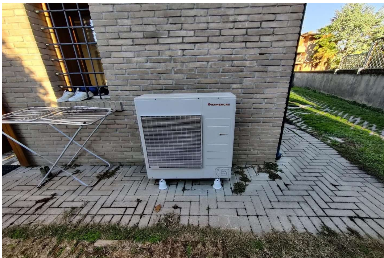
Foto n. 33 - Dotazione impiantistica. Pompa di calore.
