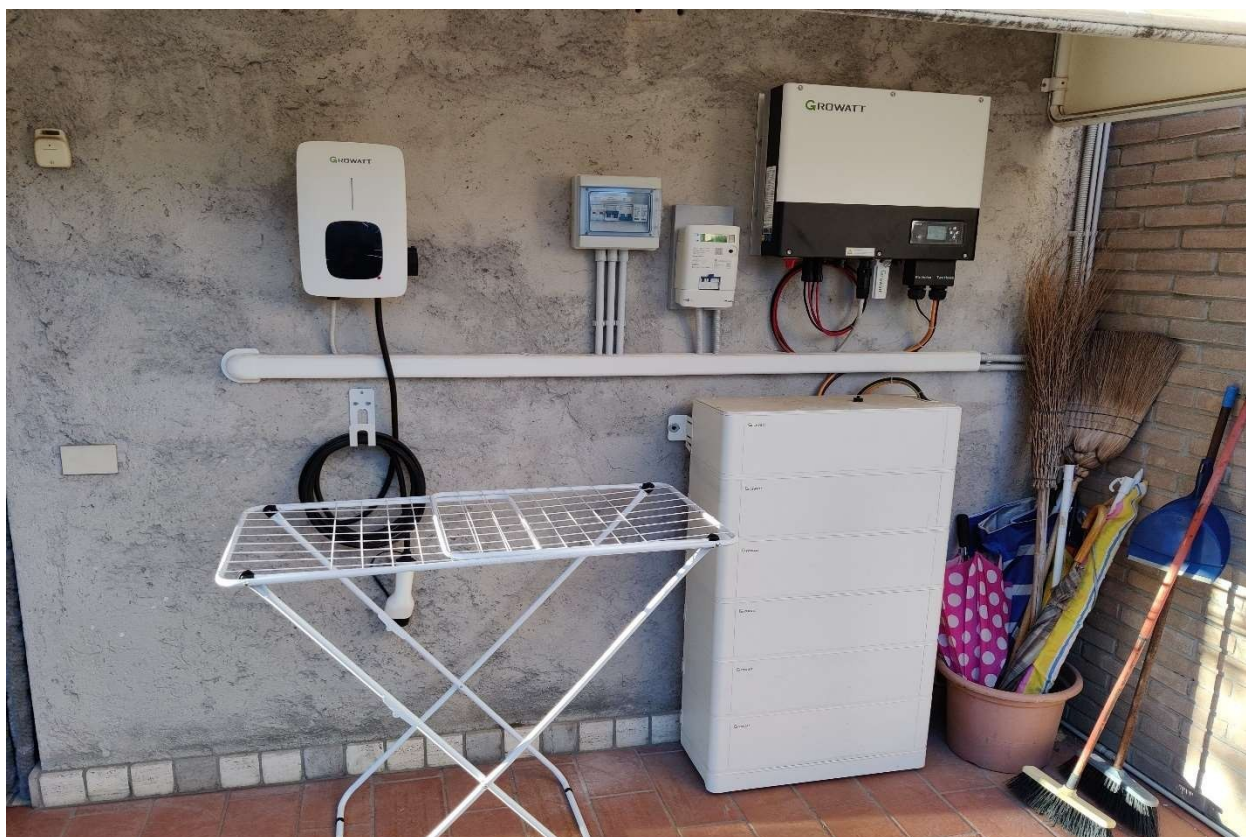
Foto n. 30 - Dotazione impiantistica: Inverter, batterie d'accumulo e carica per auto elettriche.
