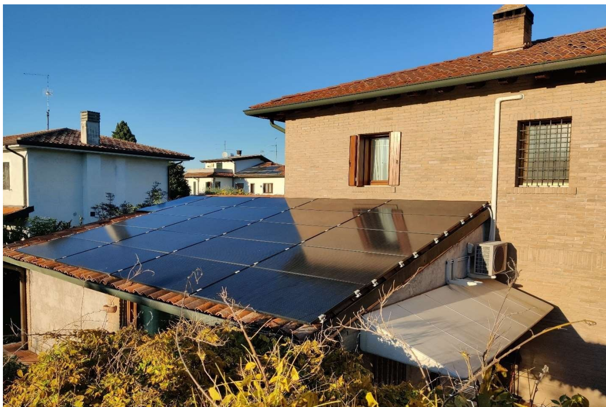
Foto n. 31 - Dotazione impiantistica. 21 Pannelli fotovoltaici. Macchina esterna per la climatizzazione.
