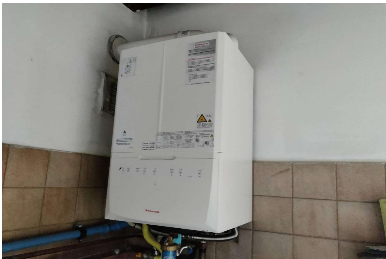
Foto n. 32 - Dotazione impiantistica. Caldaia a gas.
