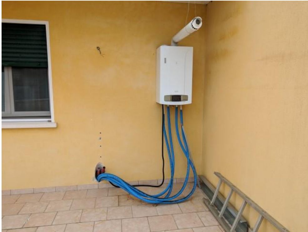
FOTO 29: PARTICOLARE CALDAIA (TERRAZZO AL P.T.)
