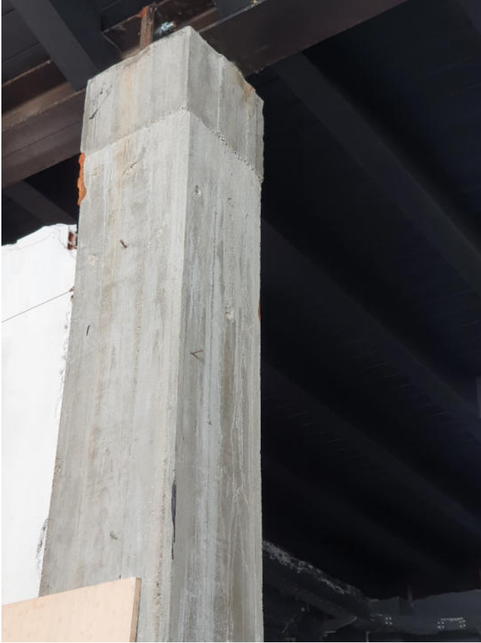
Pilastro in cemento armato e tracce di percolamento d'acqua
