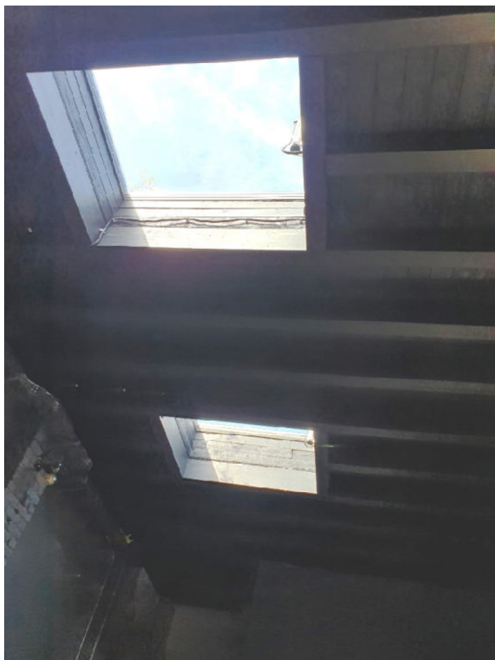
Particolare dei lucernari elettrificati
