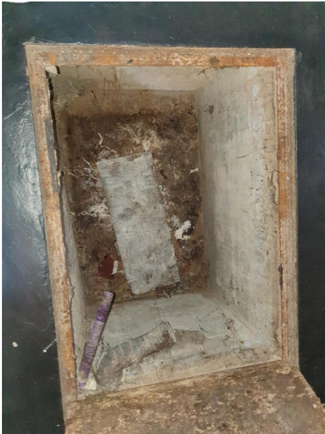
pozzetto inutilizzato a pavimento del bagno principale
