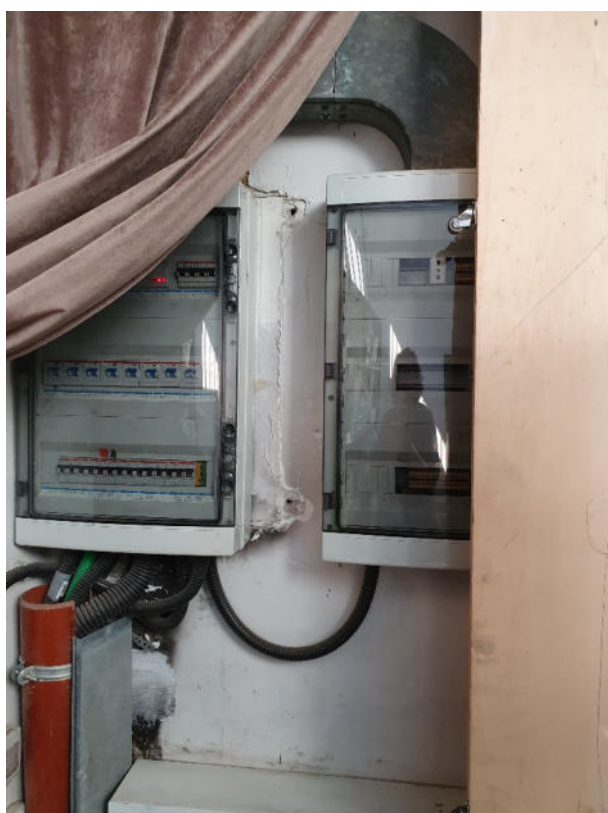
Centralina elettrica presso ingresso
