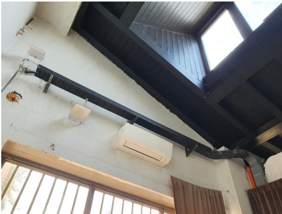
Particolari degli Impianti e finiture a vista non completati
