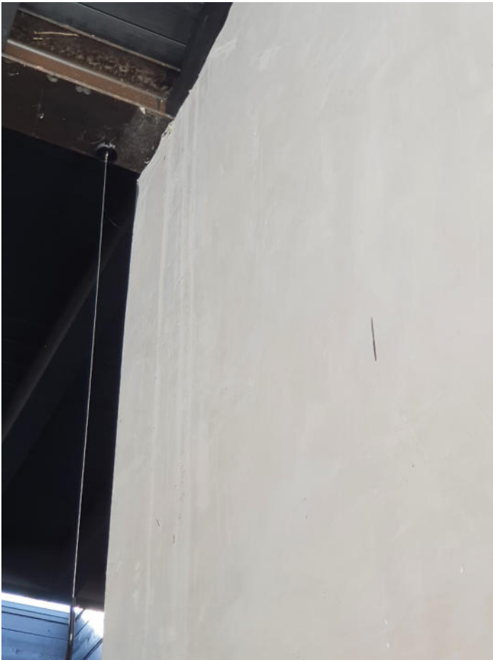
tracce di percolamento d'acqua sulle pareti
