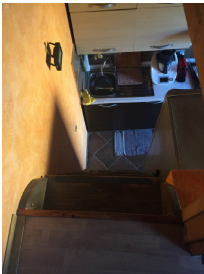
Foto 26 - Scala alla marinara di accesso al soppalco
