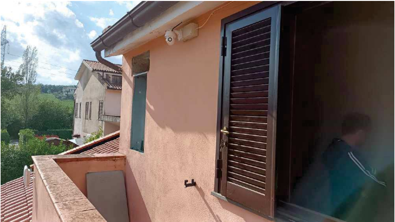
Fotografia n. 29 (Terrazzo Sud - particolare predisposizione caldaia)
