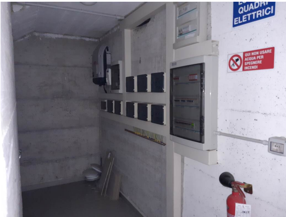
Foto 12 – Il locale contatori al piano interrato.
