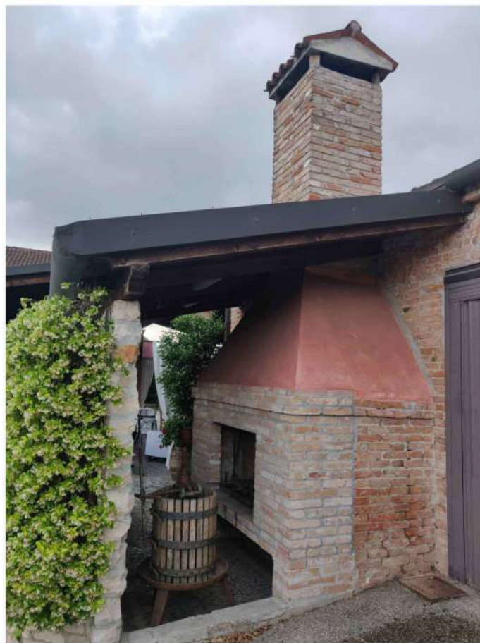
foto 10: veduta della canna fumaria, tettoia, muretto in difformità
