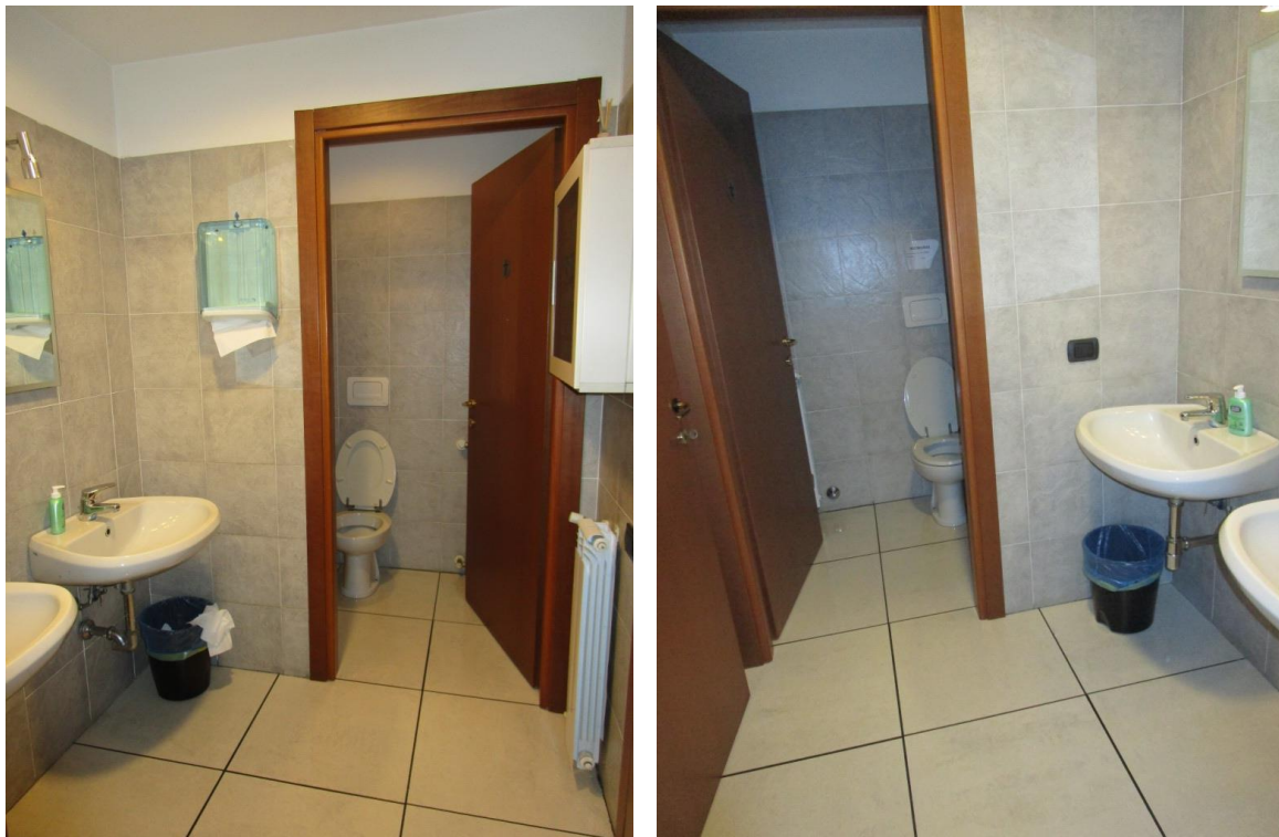
SERVIZI IGIENICI ALL'INTERNO DELL'UFFICIO – LABORATORIO OPEN SPACE
