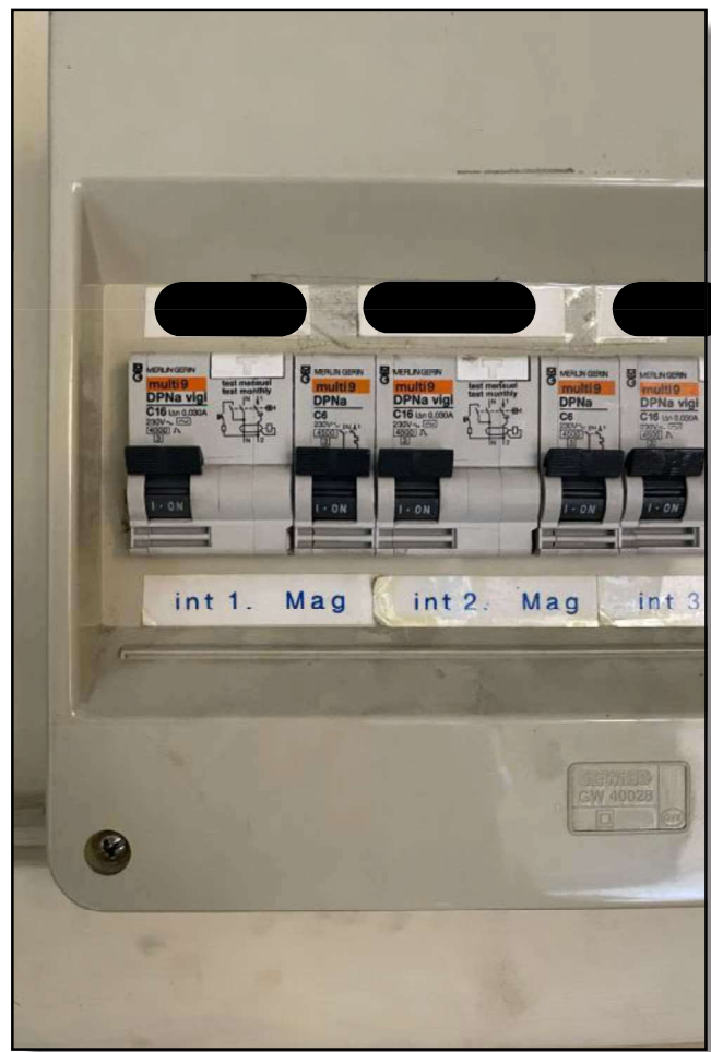
Foto n. 20) Vista del magnetotermico al p.t.
