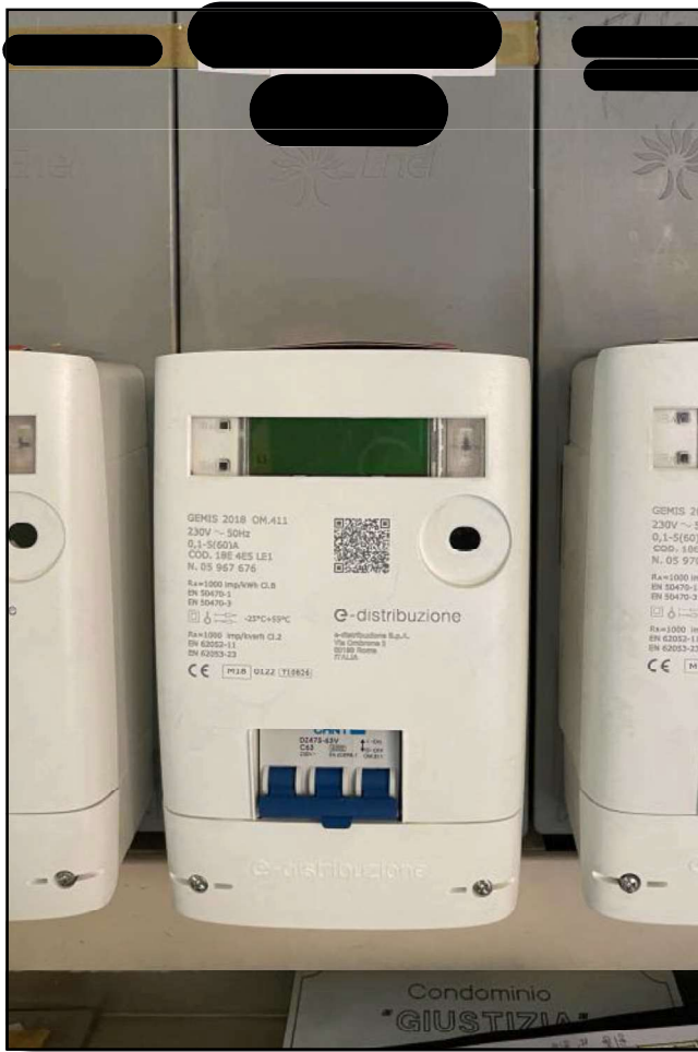
Foto n. 19) Vista del contatore al piano terra
