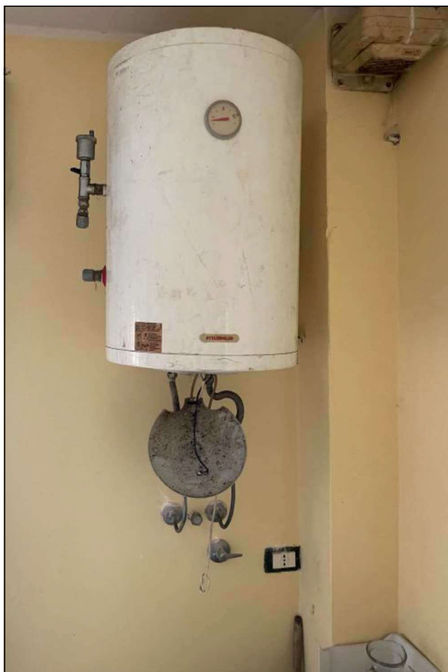
Foto n. 17) Vista del boiler per l'acqua calda
