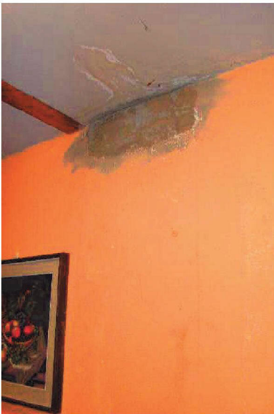
12. Dettaglio dell'infiltrazione nel corridoio di ingresso a piano seminterrato.
