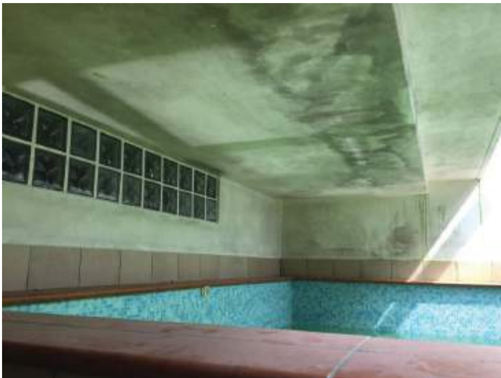
Foto n.23 – P. Cantinato – Problemi di umidità
