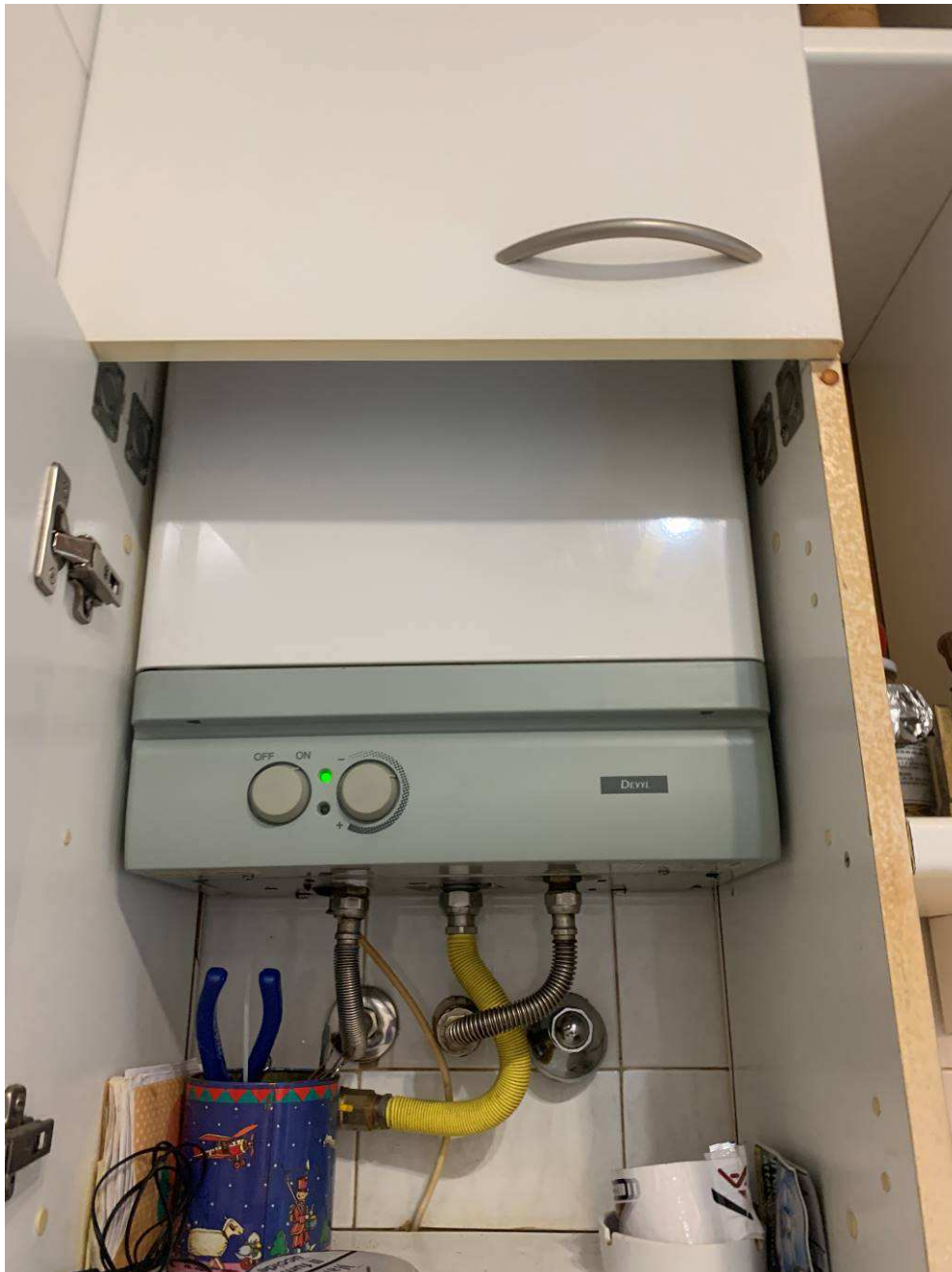
Fotografia n. 23 – Particolare dello scaldabagno a gas – modello Devyl – posizionato nel locale cucina
