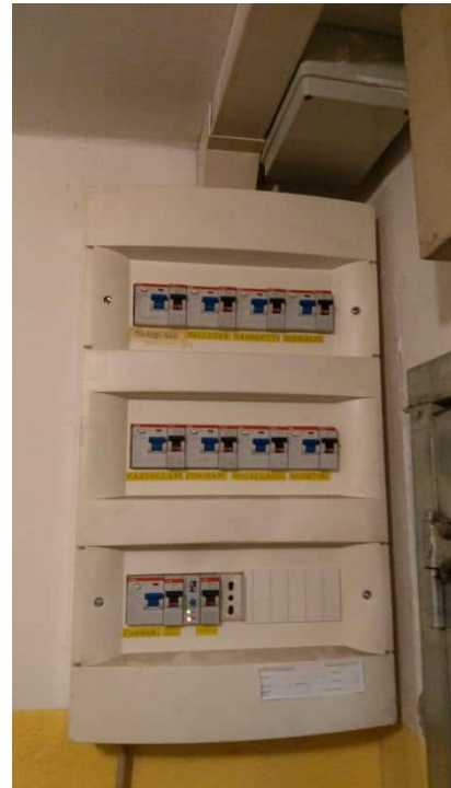
Quadro elettrico generale (ubicazione: disimpegno vani cantina)
