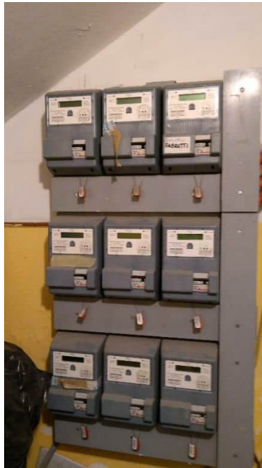
Contatore impianto elettrico (ubicazione: disimpegno vani cantina)
