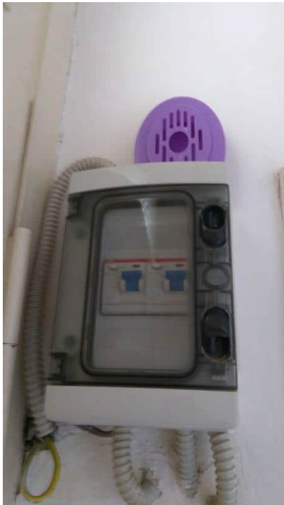
Quadro elettrico interno
