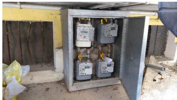
Contatore impianto gas (ubicazione: esterno fabbricato)
