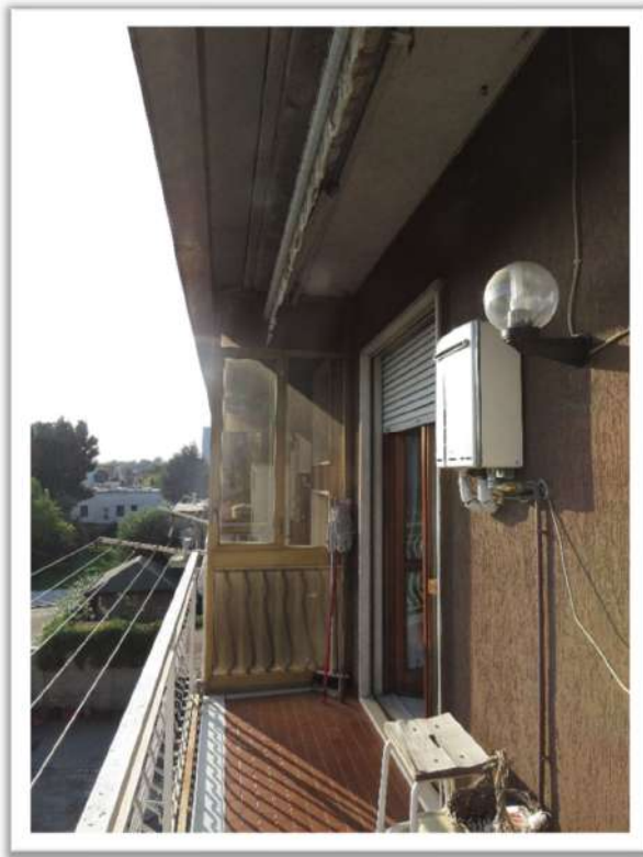
Balcone della cucina e particolare caldaia murale.
