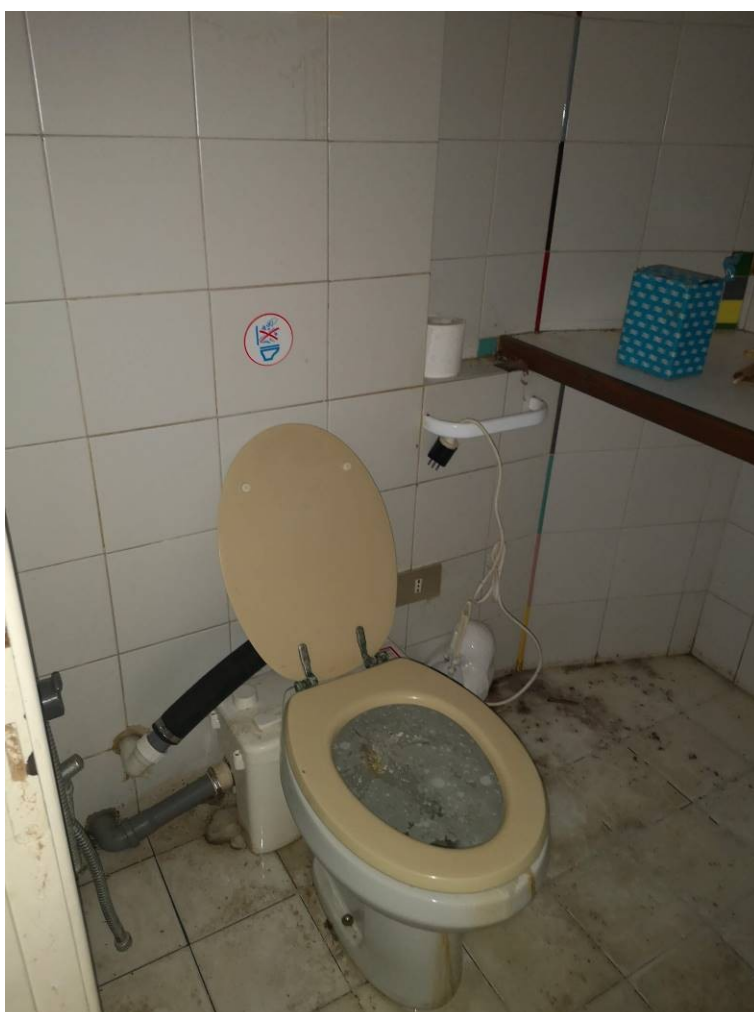
Foto 12 - Il wc con il retrostante "Sanitrit".
